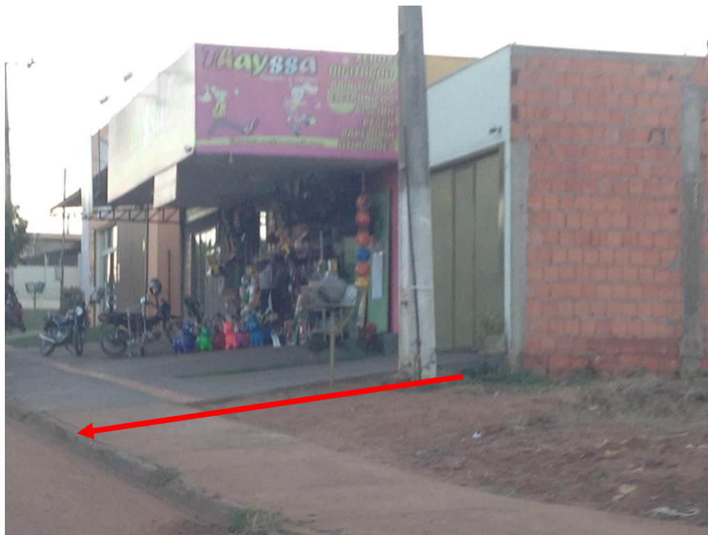
Figura 92 – Declínio no calçamento em direção a rua, presença de piso tátil e sem rampa de acesso.
