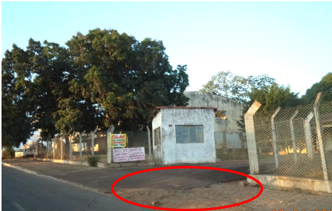
Figura 14 – Área com calçada em estado de decomposição.
