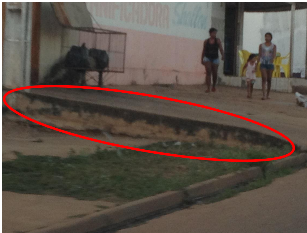
Figura 109 – Declínio do calçamento de um lote para outro.
