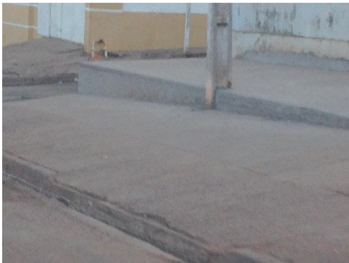
Figura 100 – Declínio da calçamento, fora da faixa de passeio da calçada.
