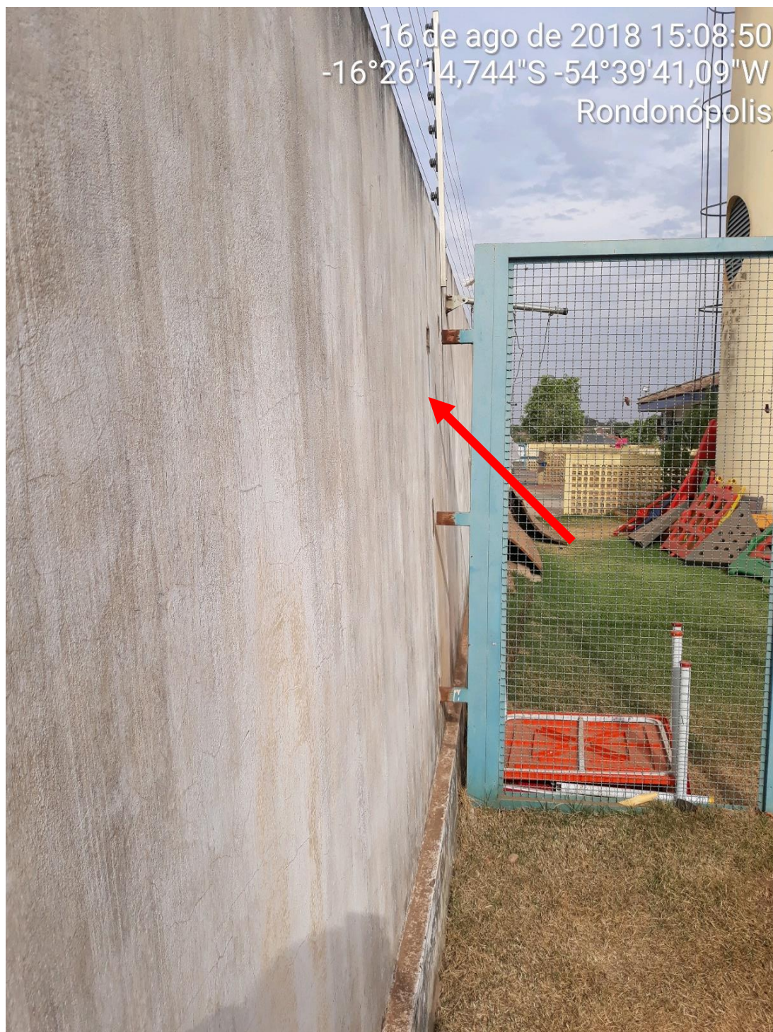
Figura 5 - Muro fora de prumo
