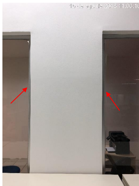
Foto 02: Detalhe da falta de requadro.
