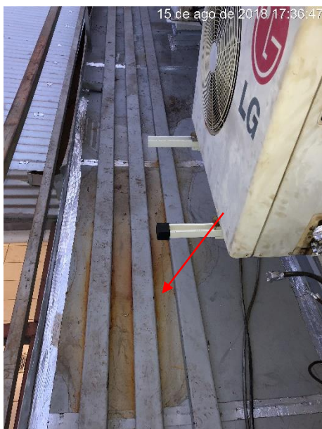
Foto 01: Chapa instalada, possível notar acúmulo de água e locais onde já não possui mais a manta asfáltica.
