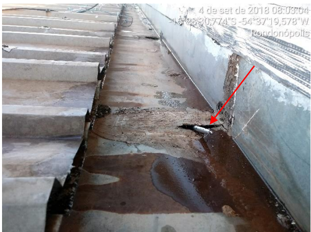
Foto 05: Detalhe da fissura na calha, a impermeabiliza- ção com a manta asfáltica, soltou. O vazamento ocorreu no gabinete da Secretaria de Planejamento.
