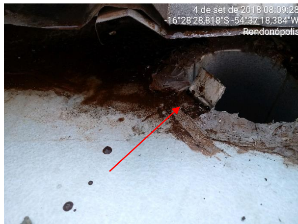
Foto 08: Nota-se que a vedação do tubo de saída (calha nova) encontra-se em desconformidade (sem o devido arrebiteamento e sem a aplicação correta do material colante. Fato esse que resultou em vazamento na calha e infiltração no teto da Sala de Reunião do Gabinete.
