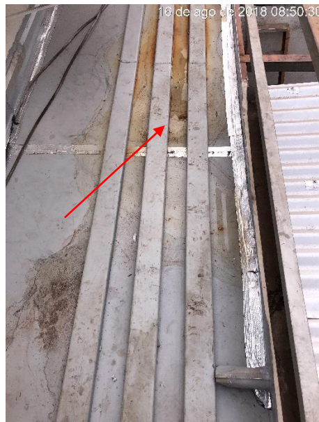
Foto 04: Chapa instalada, possível notar a- cúmulo de água.
