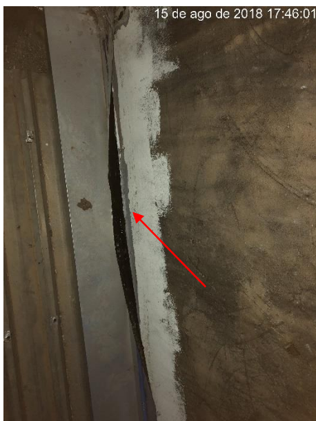
Foto 07: Nota-se em vários pontos, onde foi colocada a manta asfáltica e a mesma já descolou.
