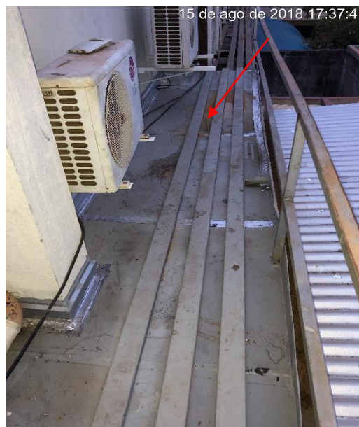
Foto 02: Chapa instalada, possível notar o acúmulo de água.
