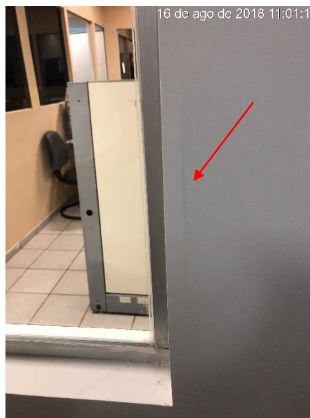
Foto 10: Detalhe da pintura manchada.
