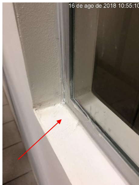
Foto 04: Detalhe da falta de acabamento.
