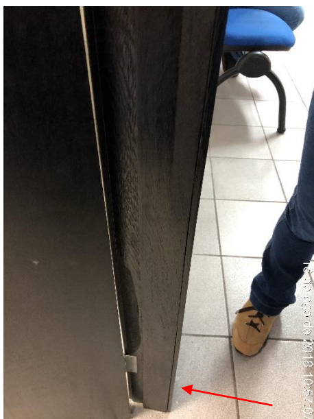
Foto 07: Detalhe da porta que apresenta problemas.
