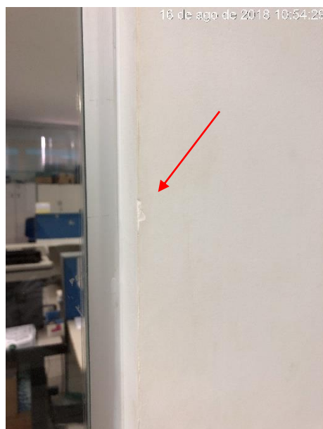
Foto 02: Detalhe de marca da placa do gesso e massa acrílica.
