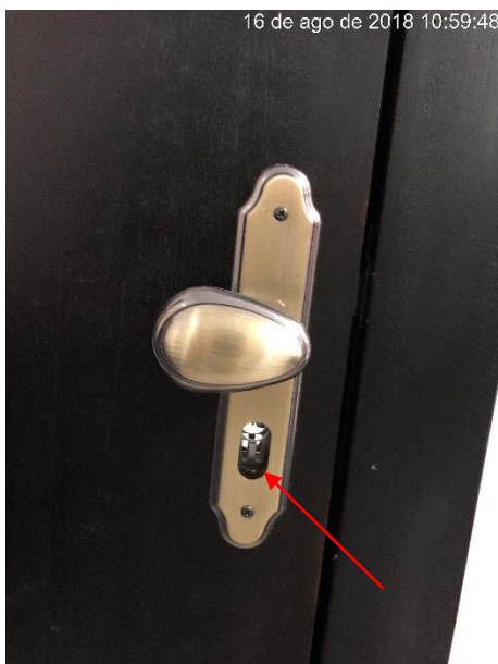
Foto 09: Detalhe da porta que já apresentou problema no miolo.
