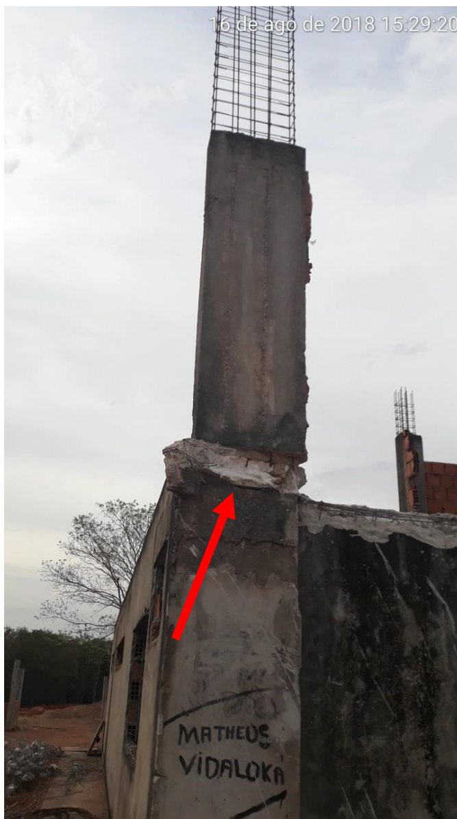
Figura 2 - Pilar sem ancoragem na face inferior, executado sobre o EPS da laje.
