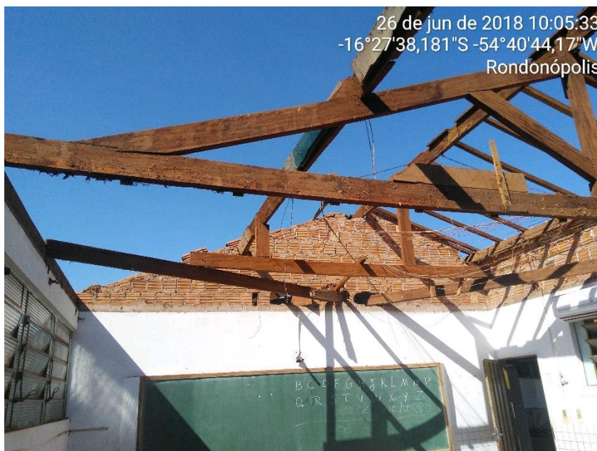
Foto 02 – Situação da Cobertura da Escola Melchiades Figueiredo Miranda
