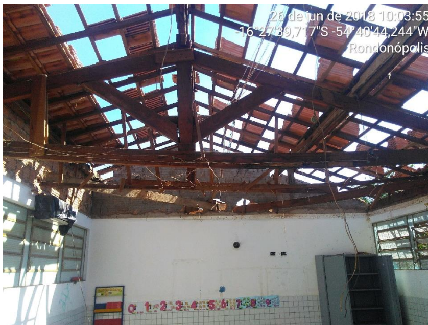
Foto 01 – Situação da Cobertura da Escola Melchiades Figueiredo Miranda
