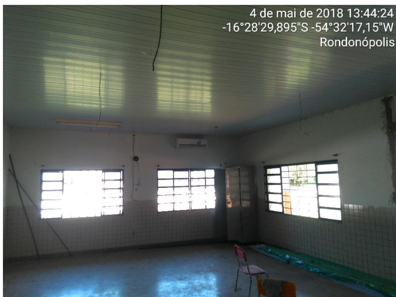
Foto 01 – Sala onde deveria estar executando o serviço (Escola Vila Paulista – Contrato 349/2017)
