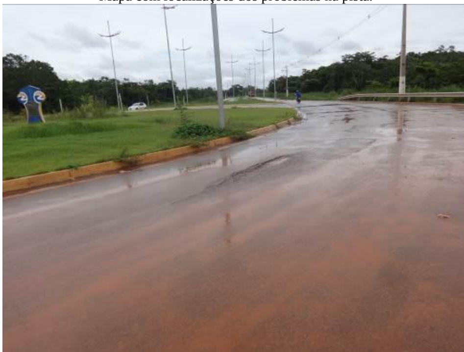
Foto sentido centro – Pista Danificada
