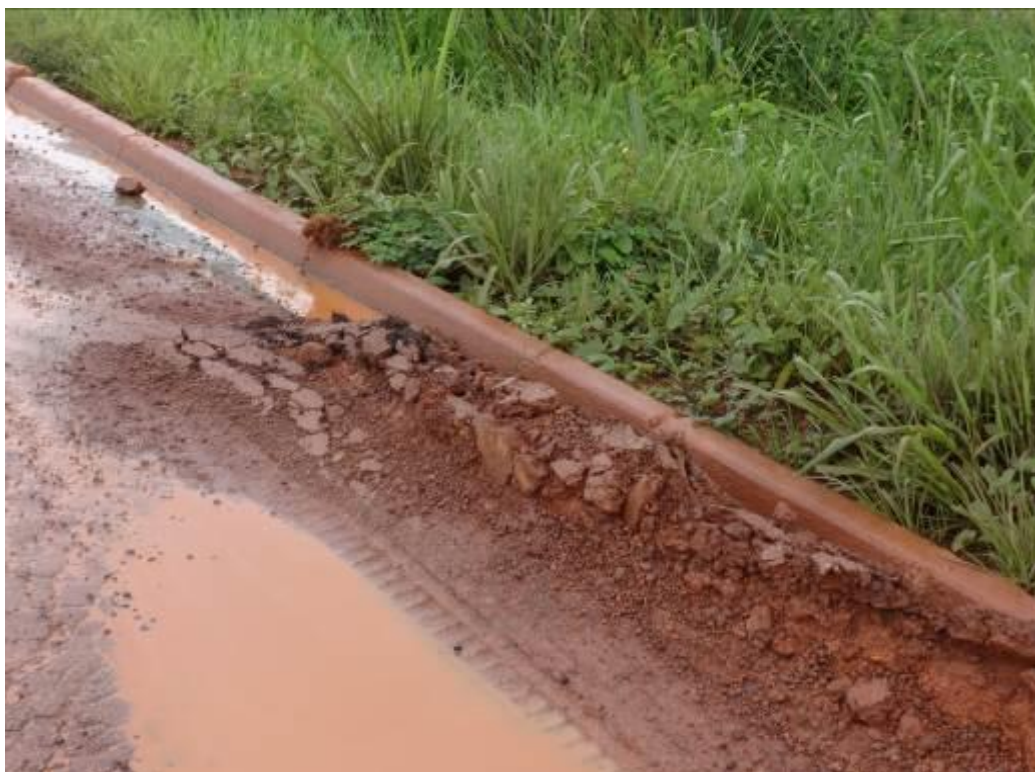
Pavimento Danificado Sempre Próximo às Descidas de Água.
