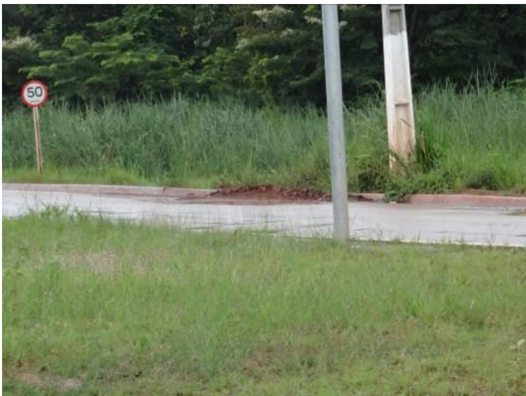
Foto sentido centro – Pista na Borda Danificada.
