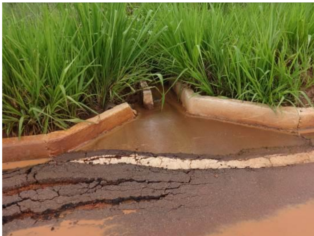
Pavimento e Descida de Água Danificados.
