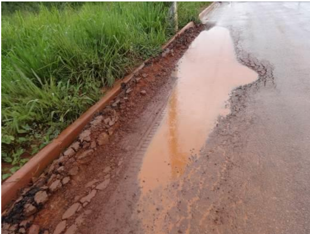
Foto sentido centro – Pista com Visão Ampliada do Problema.
