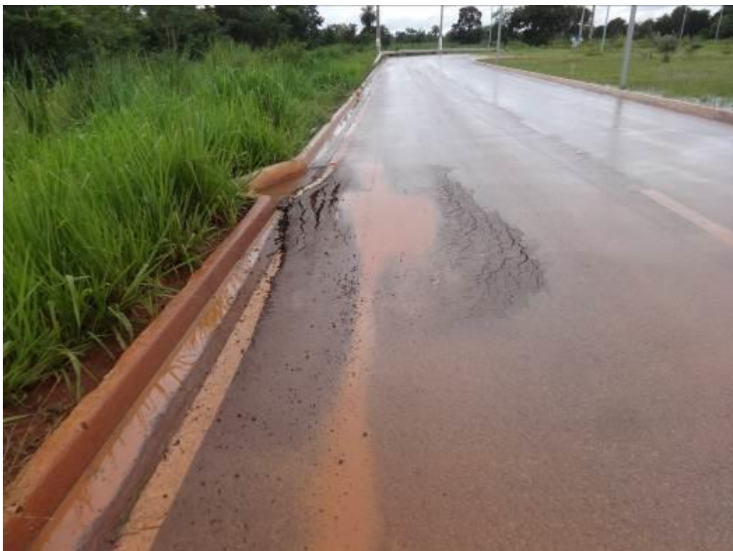
Foto sentido centro – Pontos de Descidas d'água onde Apresentam os Danos ao Pavimento.
