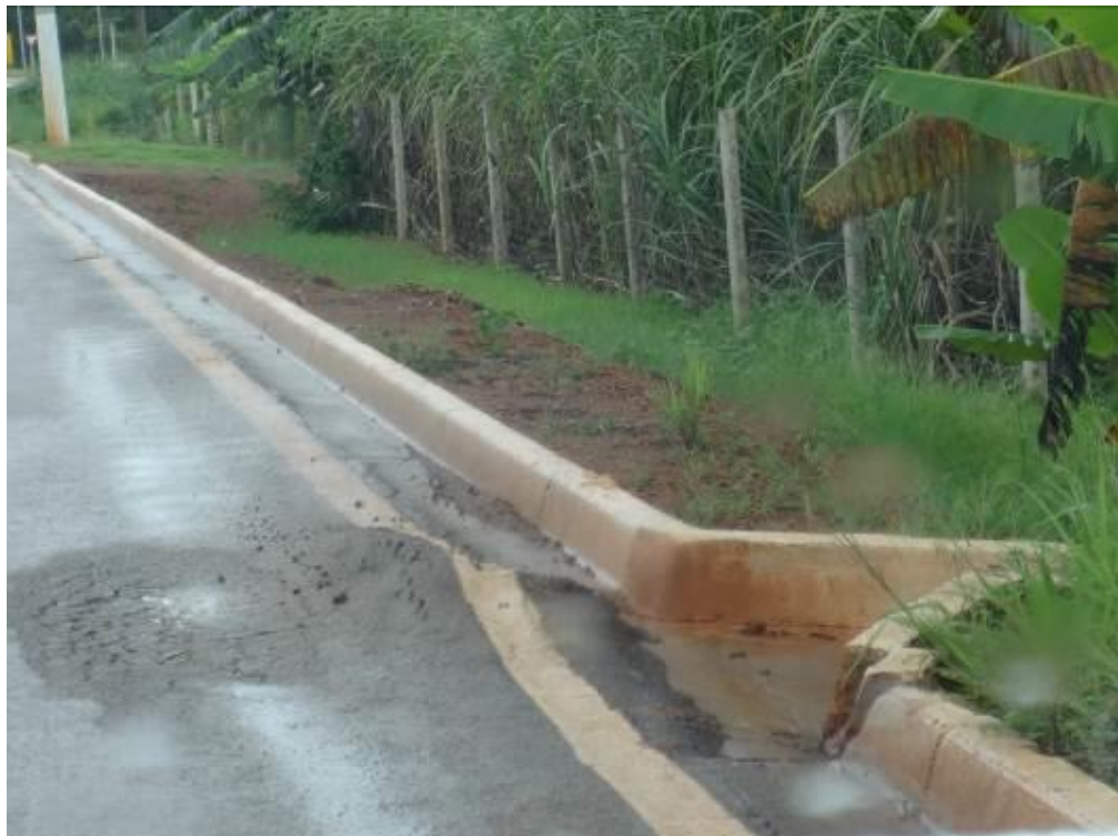
Pavimento Danificado Próximo às Saídas de Água.
