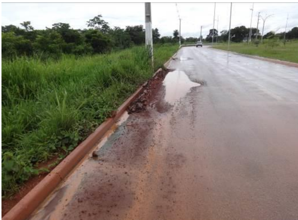
Foto sentido centro – Pista com Problemas na Capa e Base.
