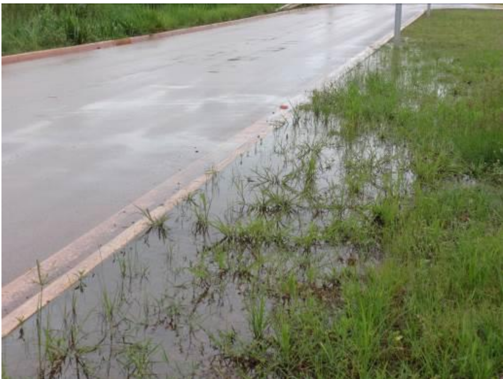
Água Acumulada no Canteiro Central.
