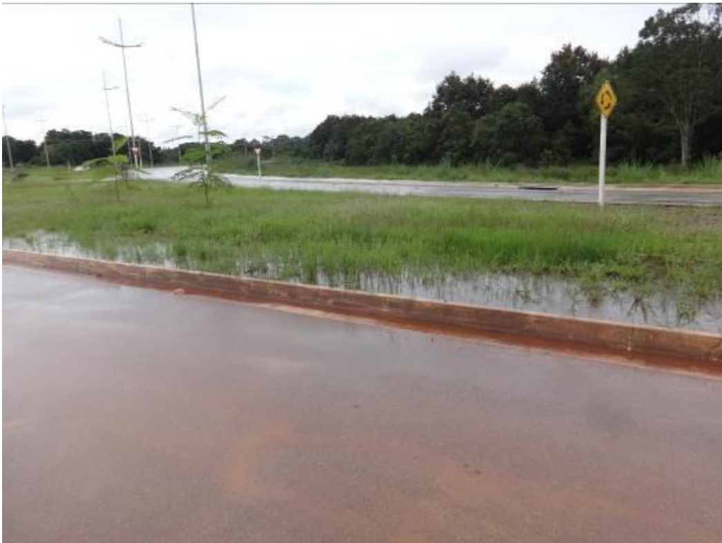
Canteiro Central com Acúmulo de Água.
