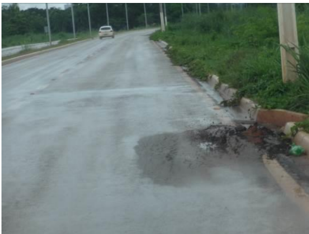
Pavimento Danificado ao Lado da Saída Água.
