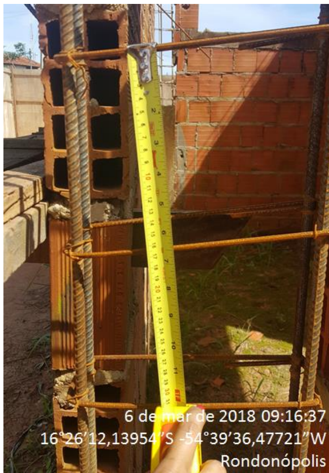
Foto 03 – Estribos com espaçamento de 16cm, conforme projeto estrutural os mesmos deveriam estar espaçados com 12cm (UBS Dom Osório – Contrato 324/2017)
