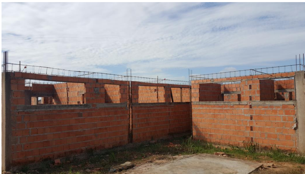
Foto 02 – Espaçamentos em inconformidade com o projeto estrutural licitado (UBS Dom Osório – Contrato 324/2017)
