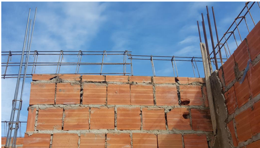
Foto 01 – Execução incorreta da viga (UBS Dom Osório – Contrato 324/2017)
