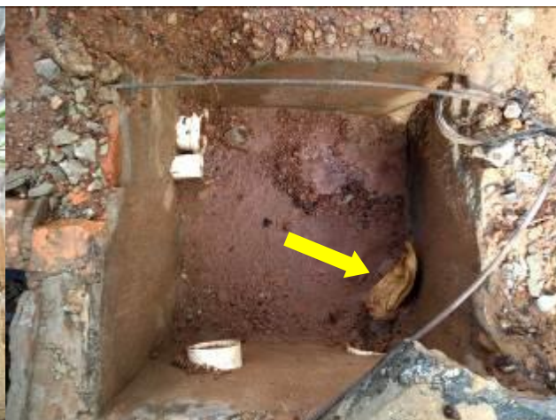
Figura 33 – Raiz de árvore encontrada na caixa de passagem
