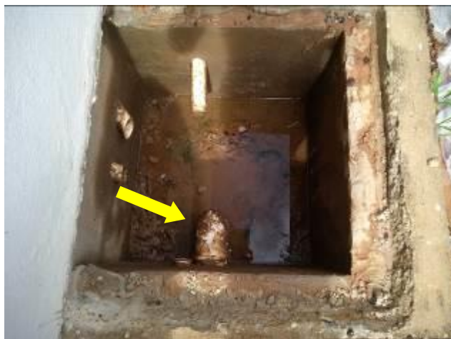
Figura 32 – Tubulação de esgoto na mesma caixa de passagem com tubulação de água servida
