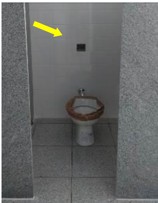
Figura 42 – Inexistência de válvula hydra, banheiro feminino
