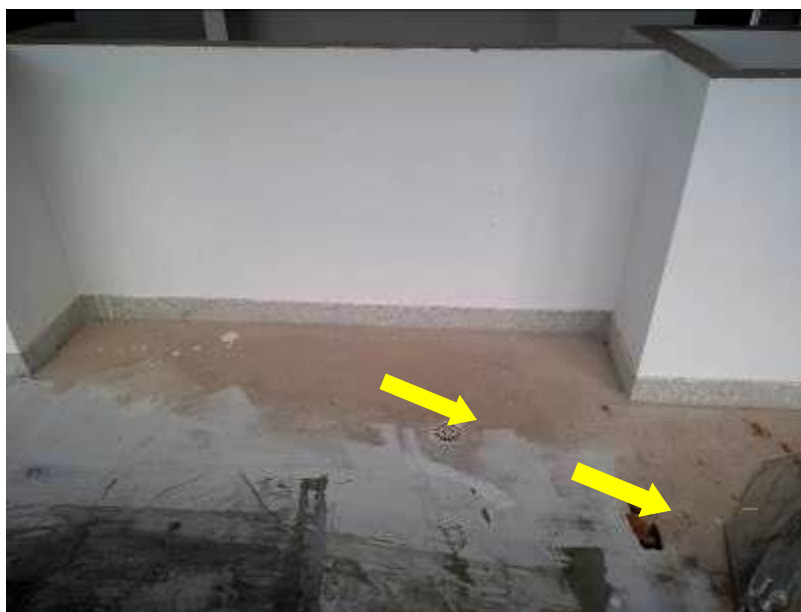
Figura 44 – Tomadas no piso próximas ao ralo
