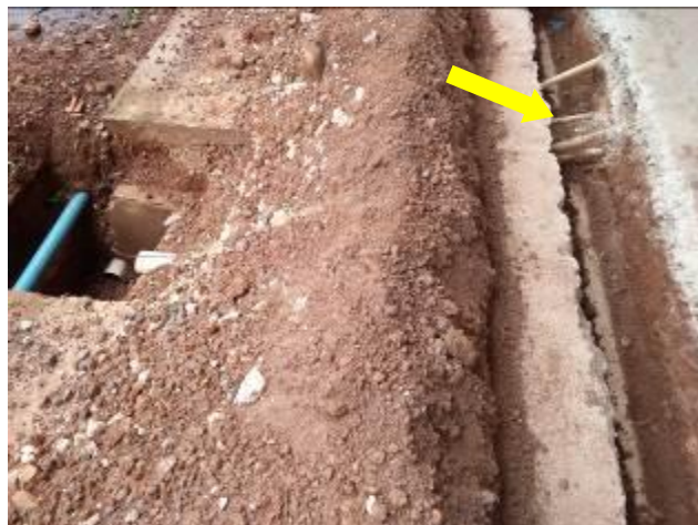
Figura 15 – Tubulações sem saída na caixa de passagem
