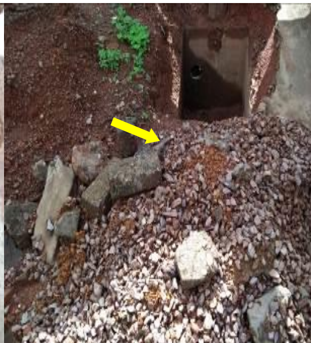
Figura 37 – Provável terra encontrada dentro da caixa de passagem
