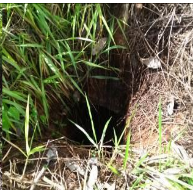
Figura 39 – Provável filtro anaeróbico e sumidouro
