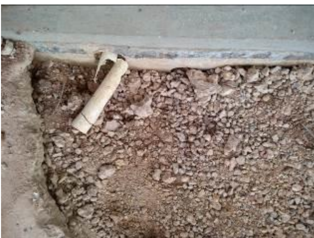
Figura 19 – Tubulação sem destinação em caixa de inspeção e/ou passagem
