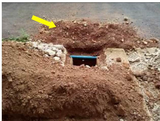
Figura 17 – Provável terra encontrada dentro da caixa de passagem
