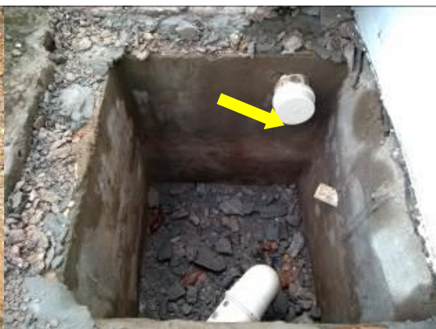
Figura 35 – Tubulação vedada com Cap
