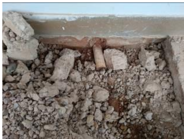
Figura 13 – Tubulação sem destinação em caixa de inspeção e/ou passagem
