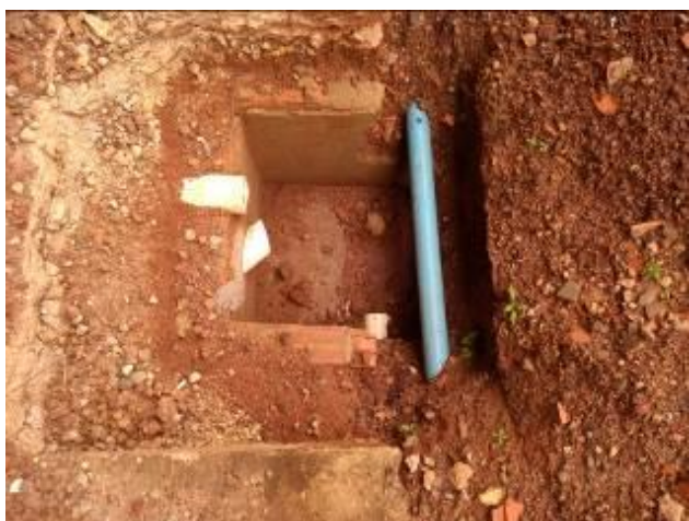
Figura 16 – Caixa de passagem sem a chegada das tubulações de esgoto
