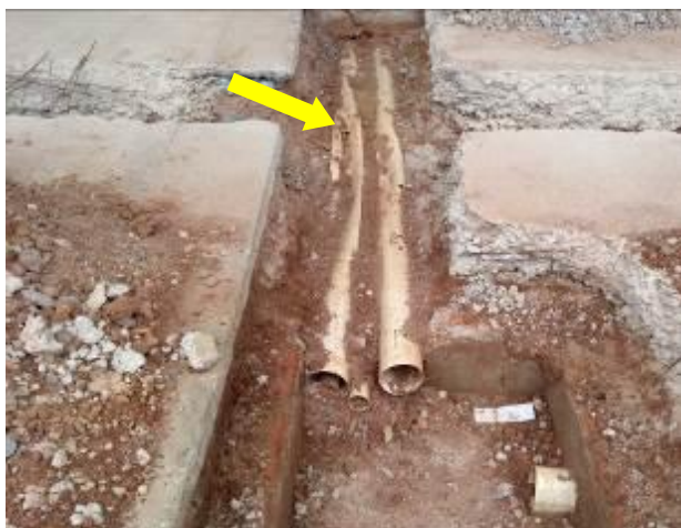
Figura 12 – Tubulação amassada e/ou quebrada
