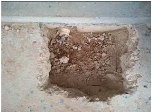
Figura 20 – Tubulação sem destinação em caixa de inspeção e/ou passagem.
