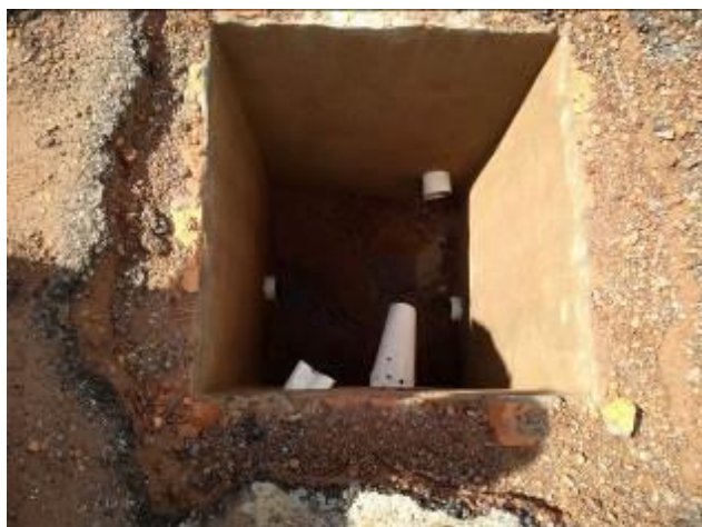
Figura 34 – Caixa de passagem com tubulações de água pluvial e esgoto juntas
