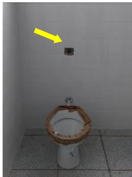
Figura 43 – Inexistência de válvula hydra, banheiro masculino
