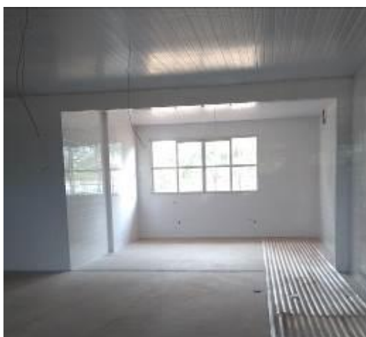
Figura 27 – Sala de manipulação de alimentos sem instalações para ar condicionado
