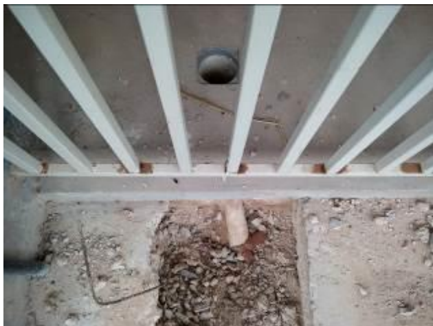
Figura 14 – Tubulação sem destinação em caixa de inspeção e/ou passagem
