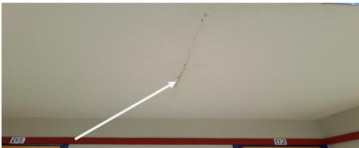
Foto 08- Fissuras nas laje
