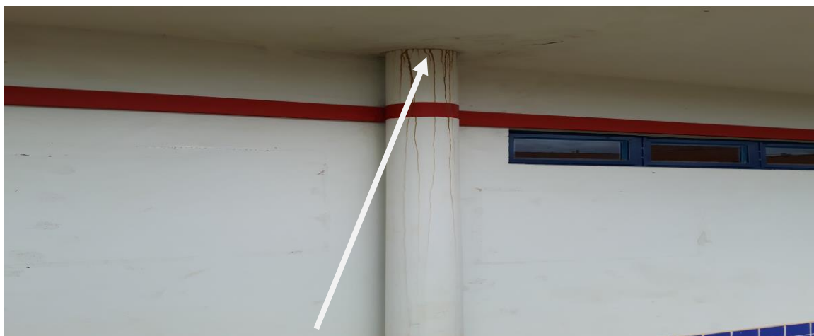
Foto 05- ponto de infiltração ao redor do tubo.
