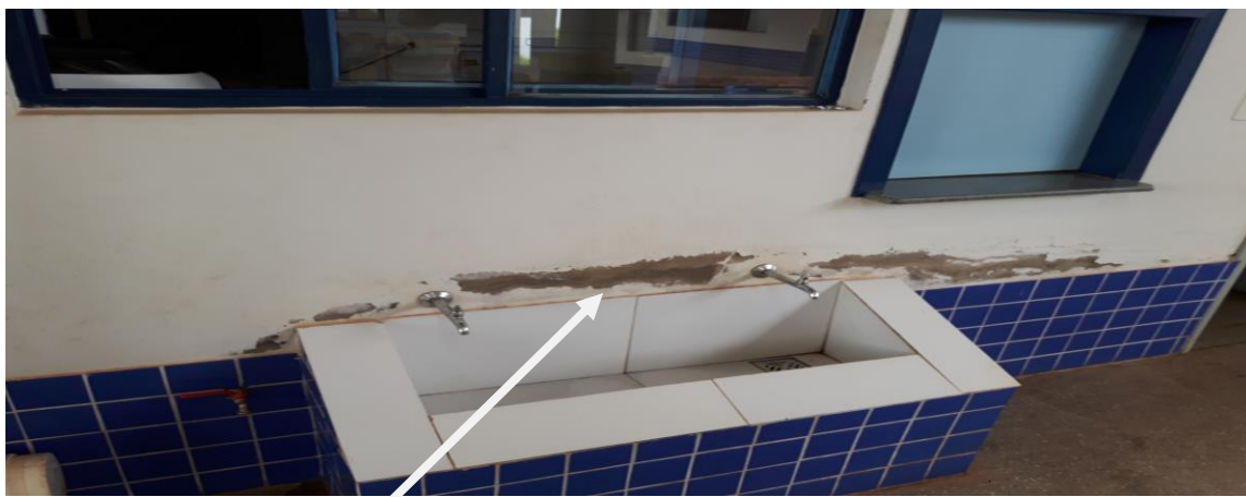
Foto 06-ponto de infiltração acima do lavatório do pátio.
