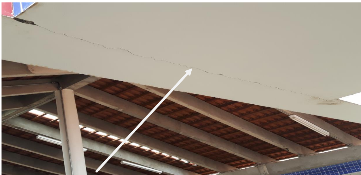
Foto 10- Fissuras na laje que liga a cobertura do pátio.
