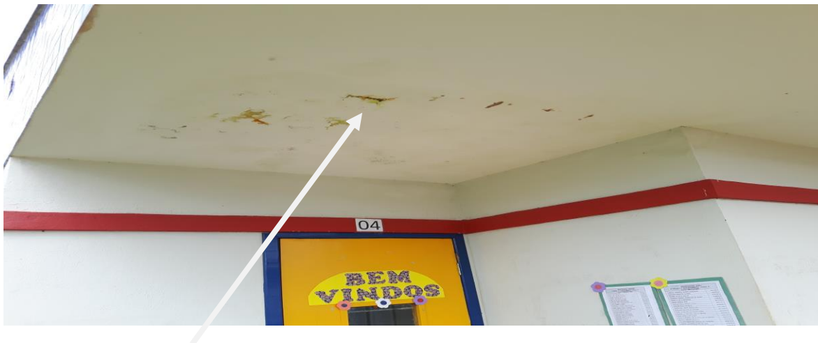
Foto 04- pontos de infiltração no teto.
