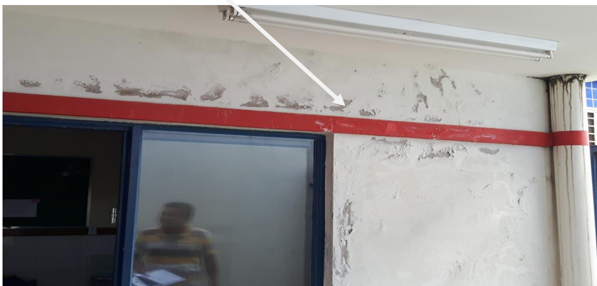
Foto 03- Ponto de umidade nas paredes.
