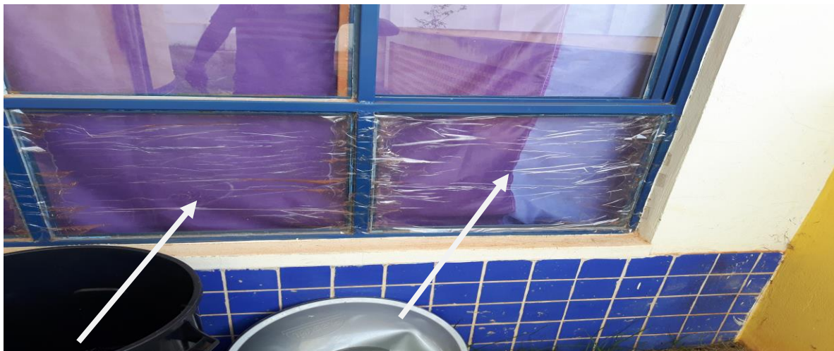
Foto 12. Janela sem vidro devido que a massa de vidraceiro ressecou vindo vidro soltar.
