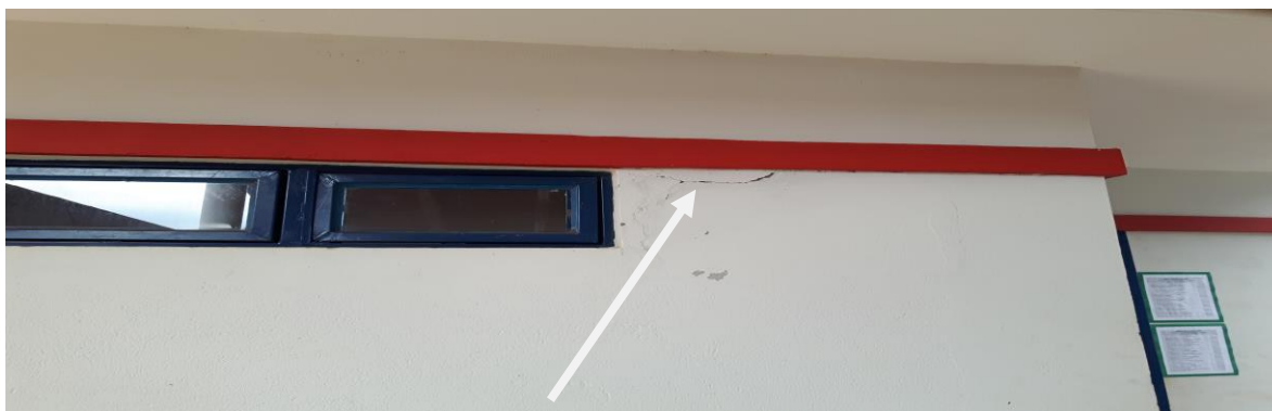
Foto 09- Trincas no lado da janelas banheiros
