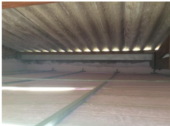
Lateral da telha sem vedação
