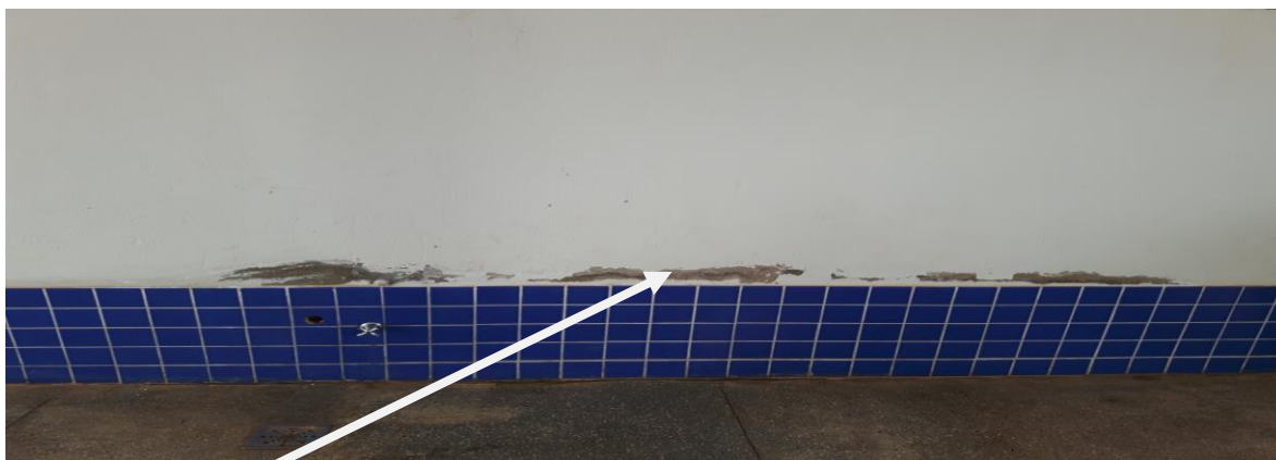
Foto 07- ponto de infiltração nas paredes.
