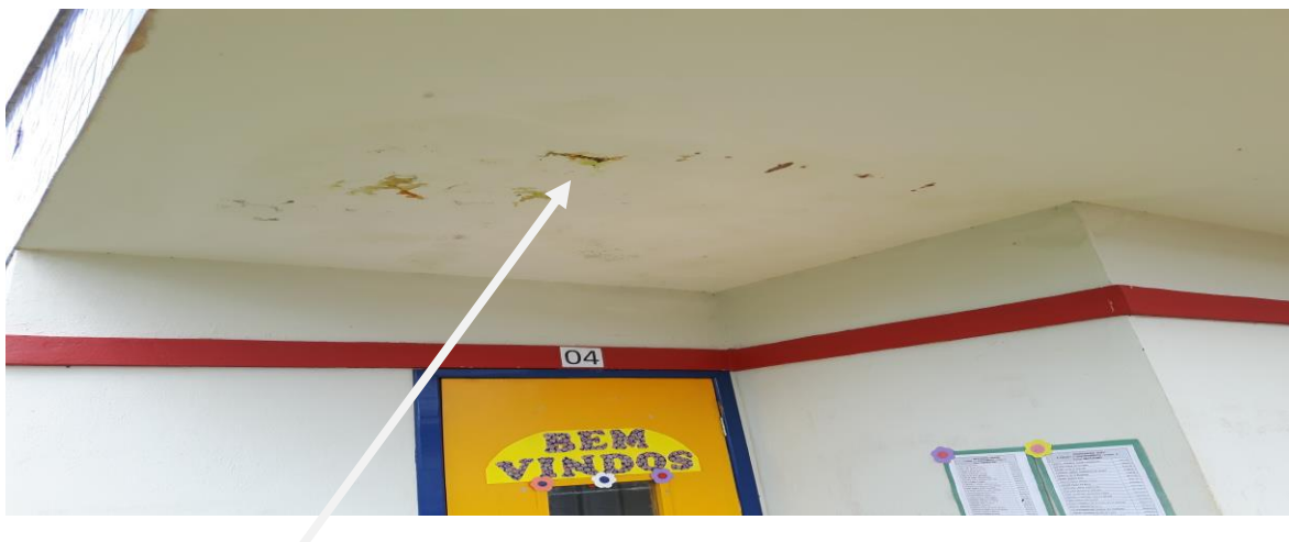
Foto 04- pontos de infiltração no teto.
