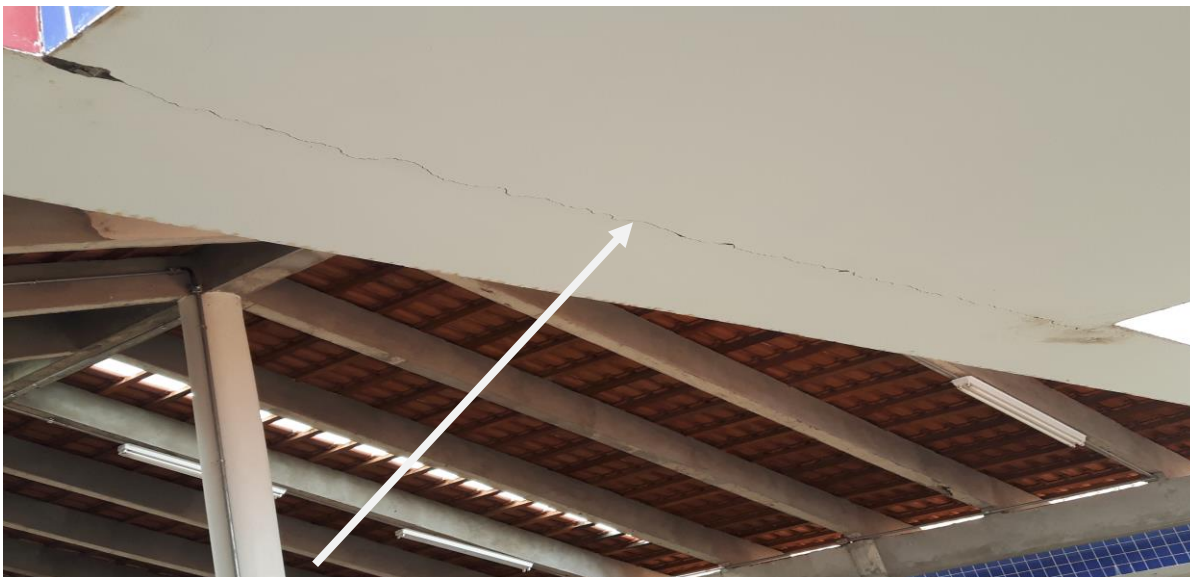
Foto 10- Fissuras na laje que liga a cobertura do pátio.
