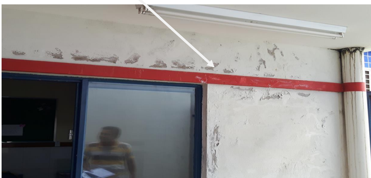
Foto 03- Ponto de umidade nas paredes.
