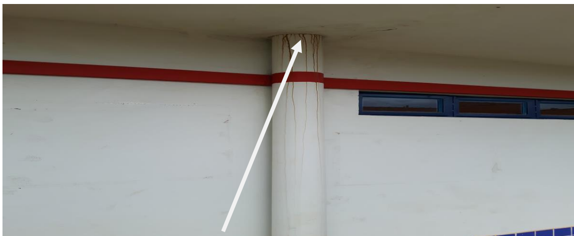
Foto 05- ponto de infiltração ao redor do tubo.
