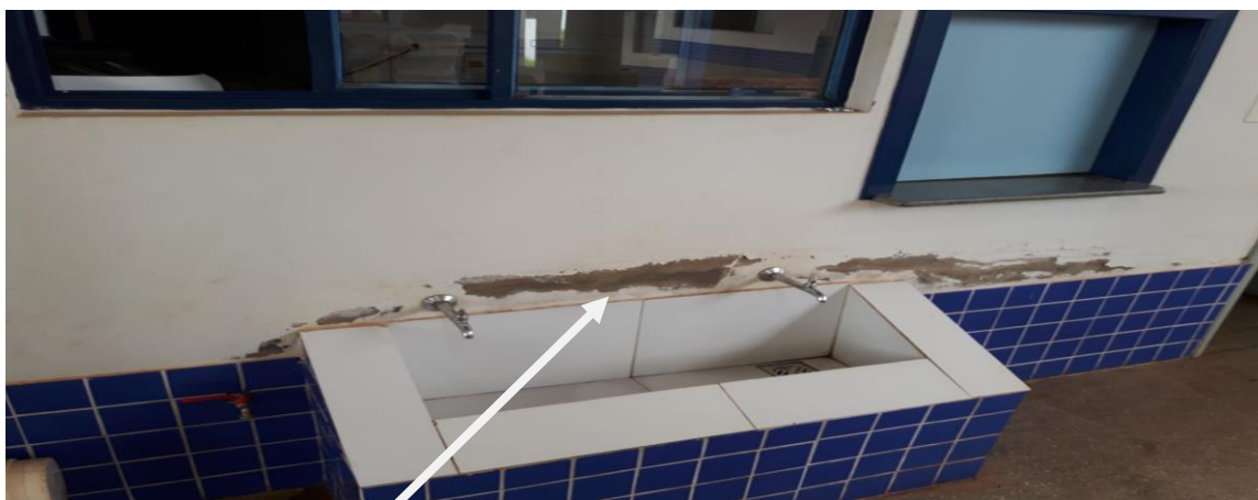
Foto 06- ponto de infiltração acima do lavatório do pátio.
