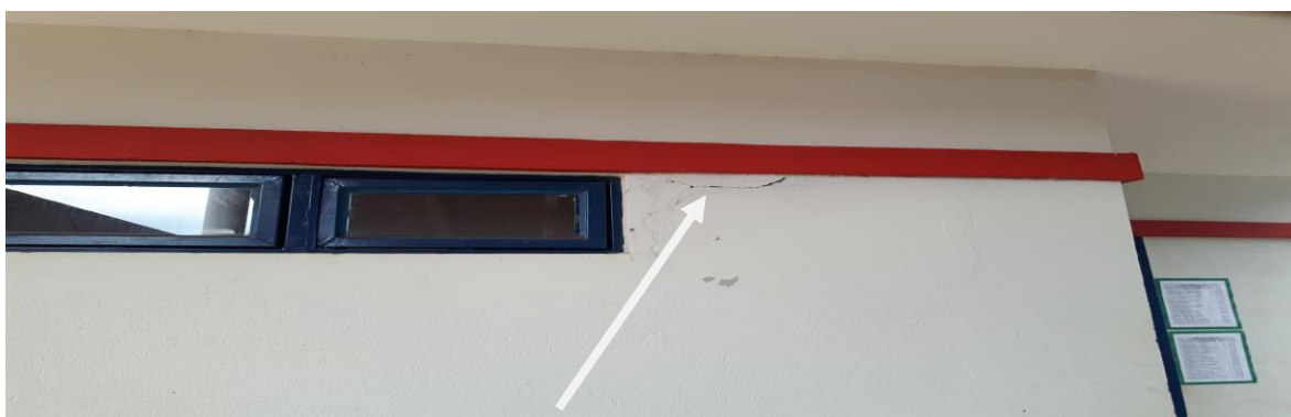
Foto 09- Trincas no lado da janelas banheiros
