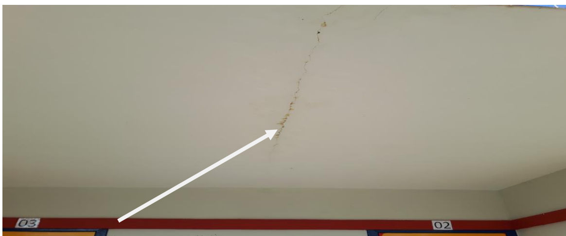
Foto 08- Fissuras nas laje
