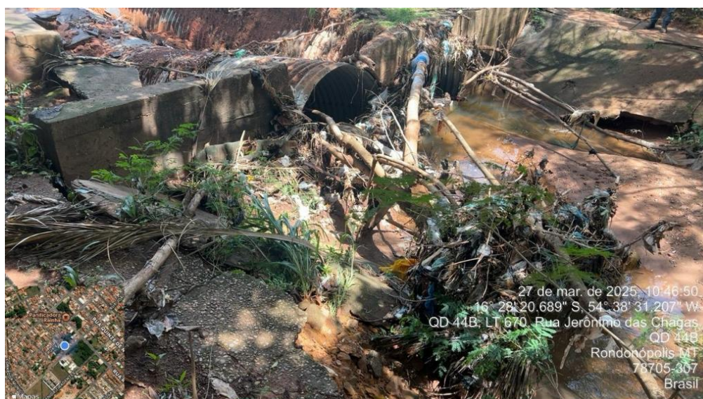
Imagem 2 - Visão do canal de drenagem com grande acúmulo de lixo, galhos e outros detritos, evidenciando a obstrução do fluxo de água e a necessidade de limpeza.
