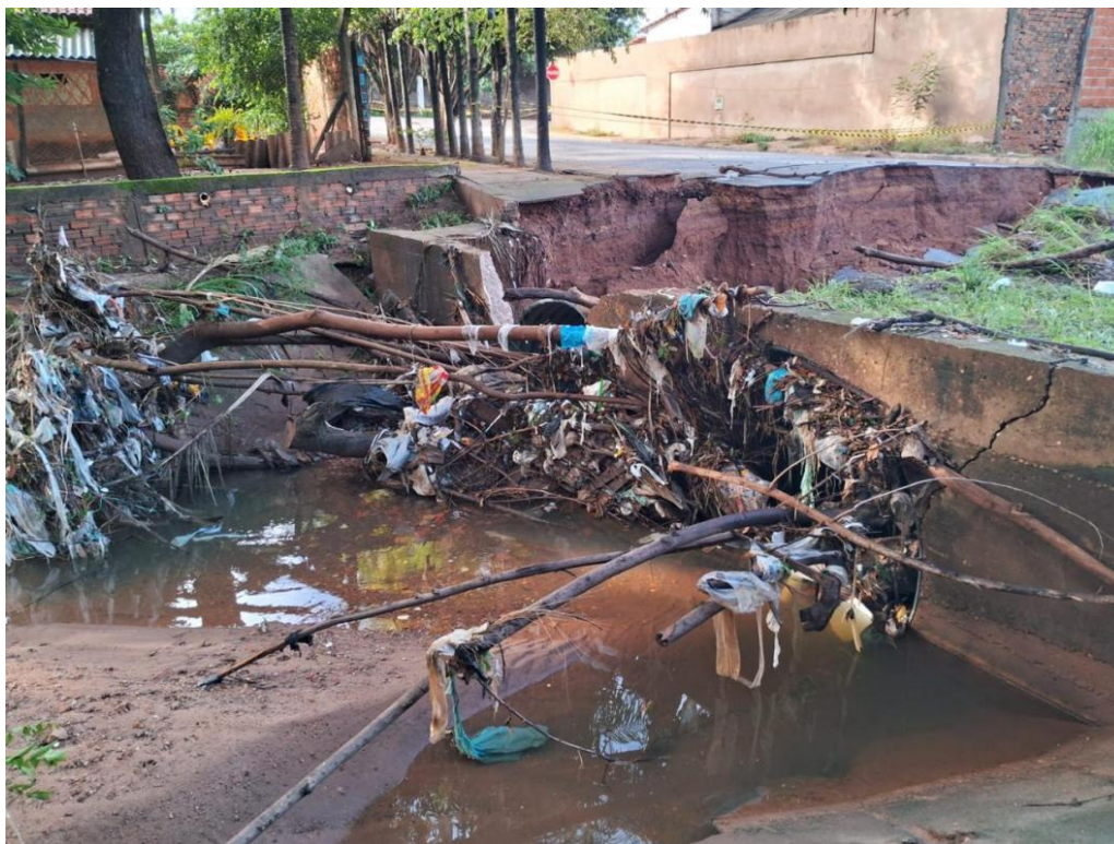
Imagem 3 - Perspectiva mais ampla da área afetada, destacando a extensão da obstrução no canal, a presença de água estagnada e os sinais de erosão nas margens.
