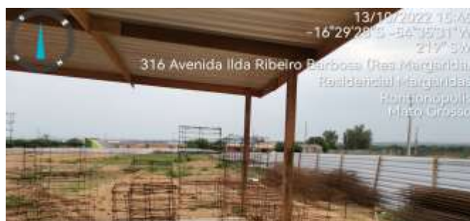
Imagem 07: Ferragem de armação exposta no chão.
