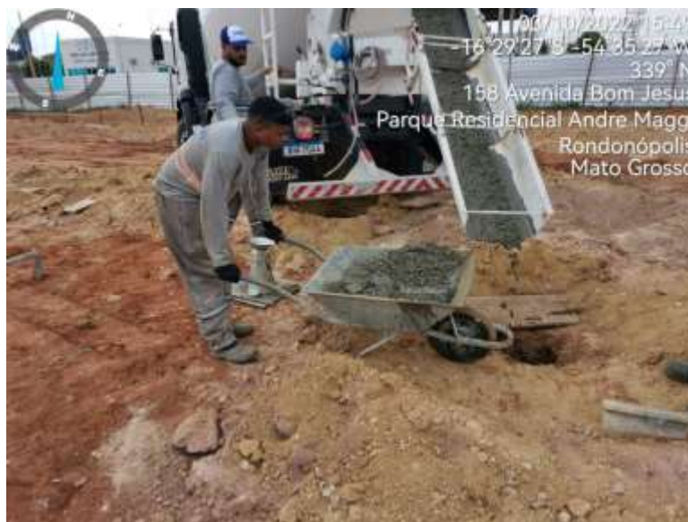
Imagem 02: Concreto retirado do caminhão com restos de sacos de cimento, pedaços de bloco cerâmico, cimento sem estar homogêneo.
