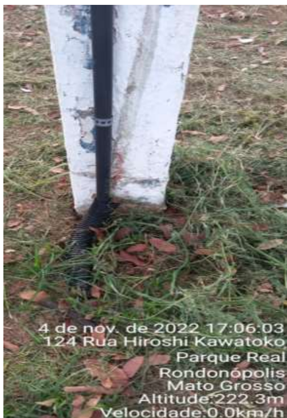
Figura 02: Eletroduto aparente na superfície
