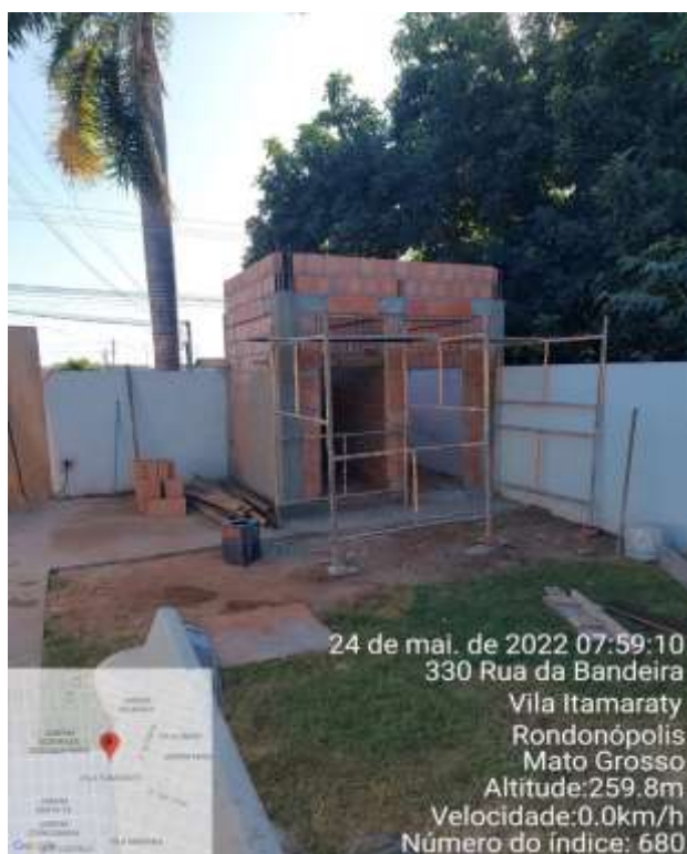
Foto 10 – Abrigo de resíduos inacabado
