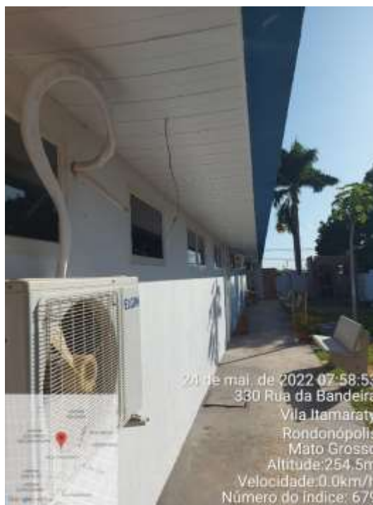
Foto 06 – faltam todas luminárias nas laterais do ESF E os refletores.
