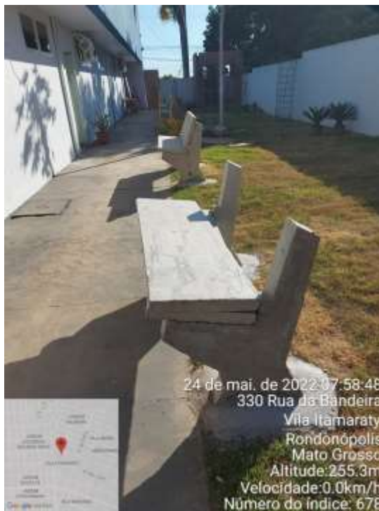
Foto 05 – falta parafusar a parte de cima de todos os bancos.
