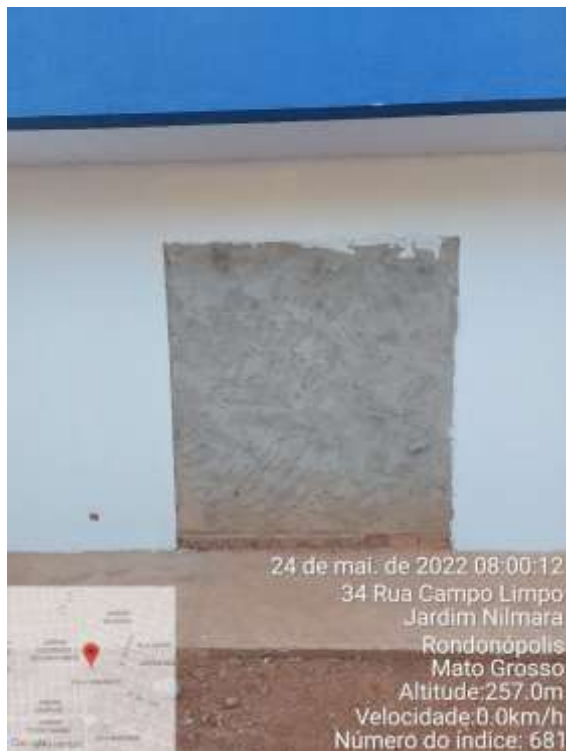
Foto 03 – Falta assentar uma janela em vidro temperado No final do corredor.
