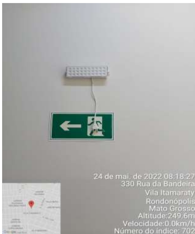
Foto 09 – instalação de todas as luminárias de Emergência estão sem tomadas
