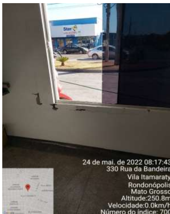
Foto 08 – Parede da janela da fachada onde a máquina quebrou na hora de remover os entulhos.
