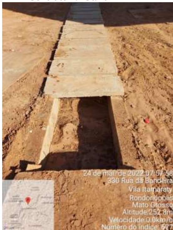
Foto 01 – Falta limpar a grelha que está entupida de terra e assentar as peças pré fabricadas.
