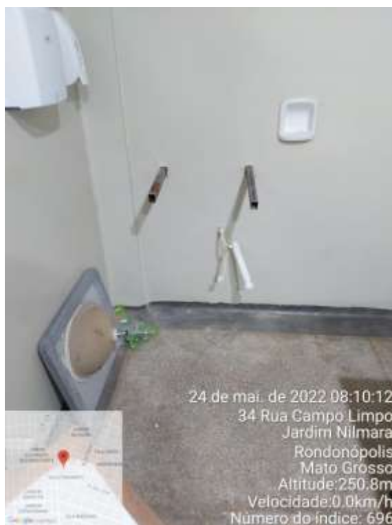
Foto 04 – falta assentar bancadas de granito completa com torneira.
