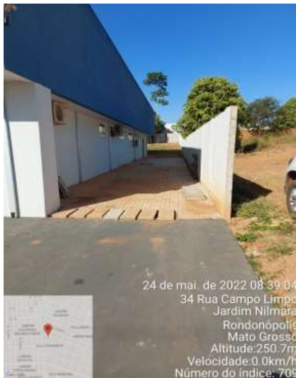
Foto 07 – Falta assentar portão na lateral do ESF.
