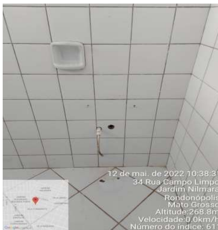
Foto 04 – falta bancada de granito completa com torneira.
