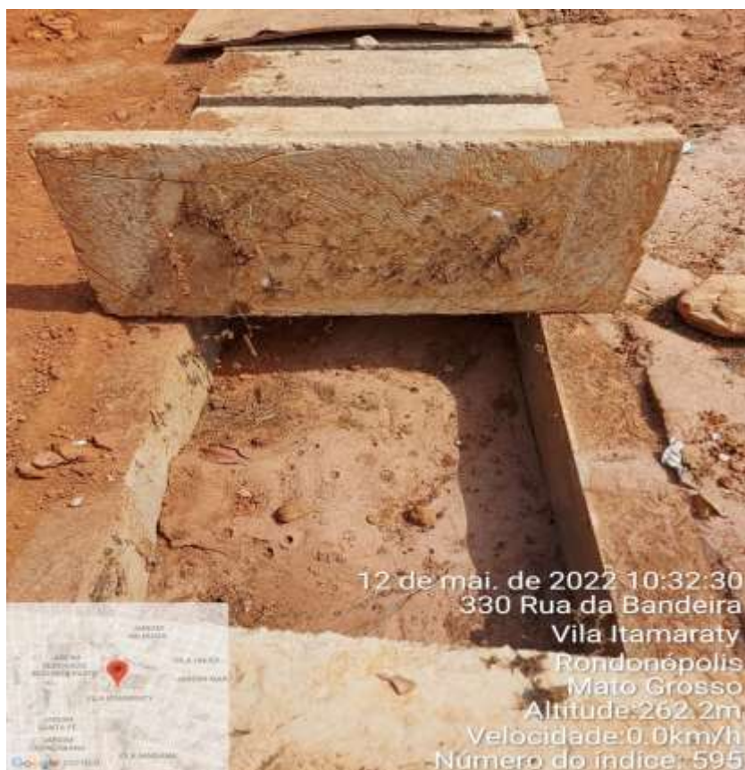
Foto 03 – Drenagem de água pluvial no fundo do ESF entupida de terra.
