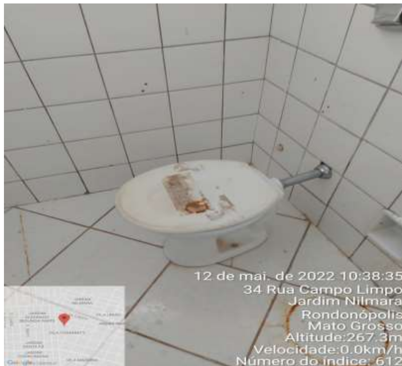
Foto 11 – Assento sanitário velho, vazamento em canalização
