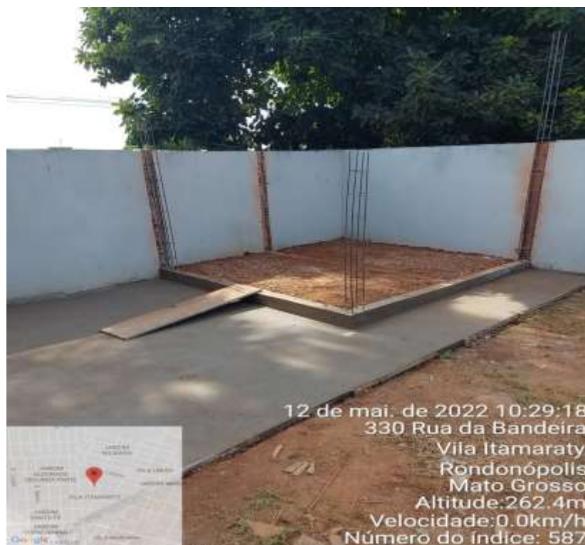
Foto 10 – Abrigo de resíduos inacabado
