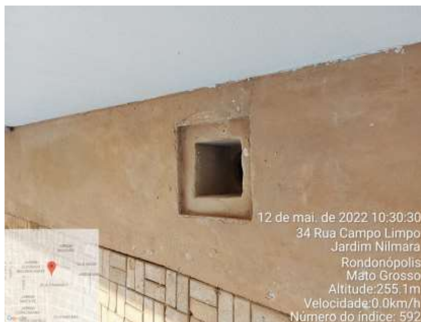
Foto 12 – caixa de passagem sem tampa, e algumas caixas
