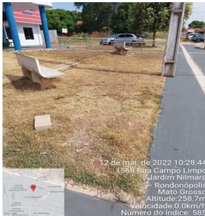
Foto 07 – falta colocar meio-fio separando a calçada da grama, e falta assentar as gramas.
