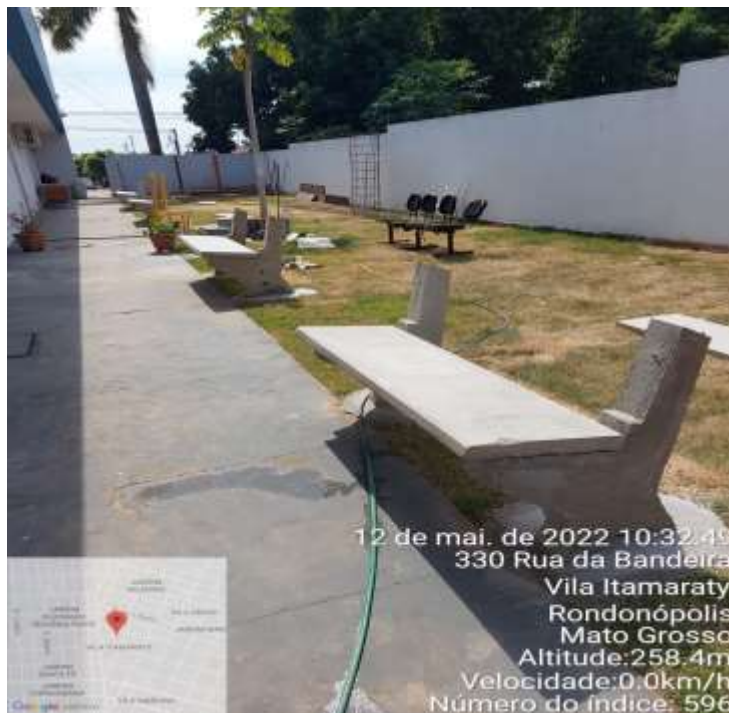
Foto 05 – falta parafusar a parte de cima dos bancos.
