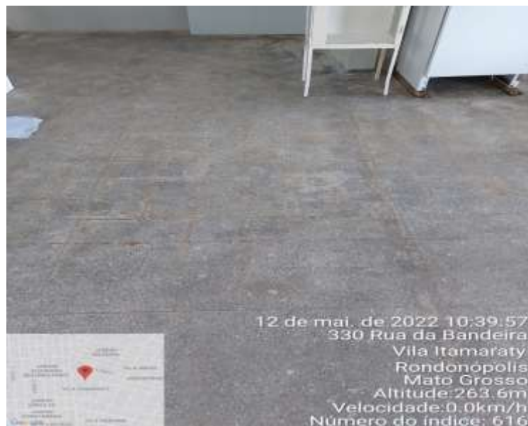
Foto 09 – Piso granilite manchado de ferrugem da malha de ferro Que deixaram na recepção, falta limpar e passar resina
