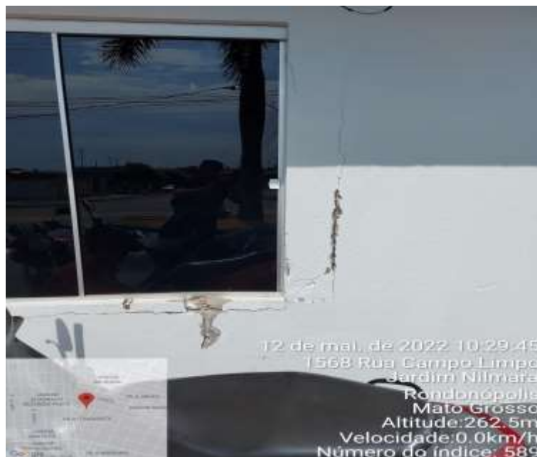
Foto 08 – Parede da janela da fachada onde a máquina quebrou na Hora de remover os entulhos.
