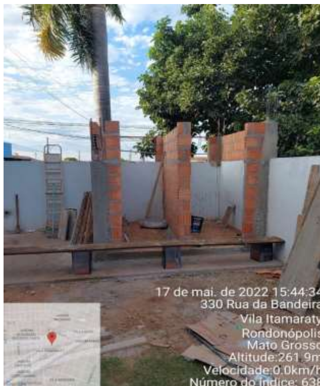
Foto 10 – Abrigo de resíduos inacabado
