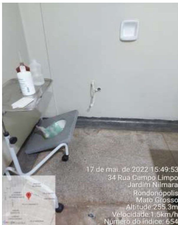
Foto 04 – falta assentar bancadas de granito completa com torneira.
