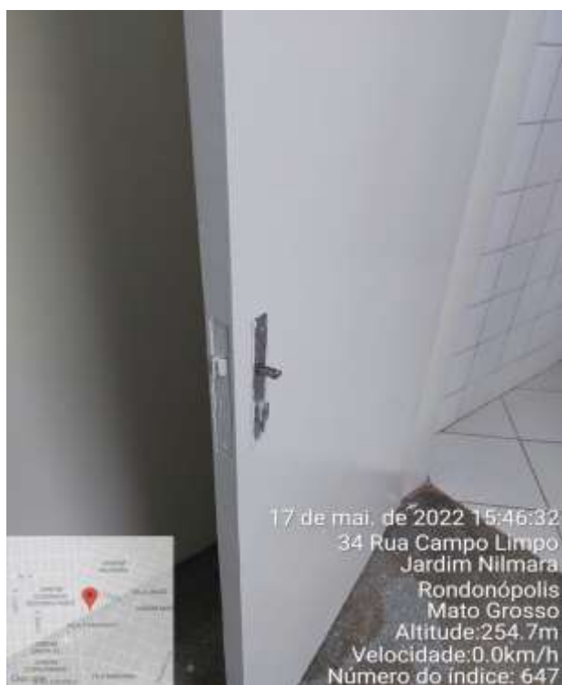
Foto 03 – Falta fechadura em algumas portas.
