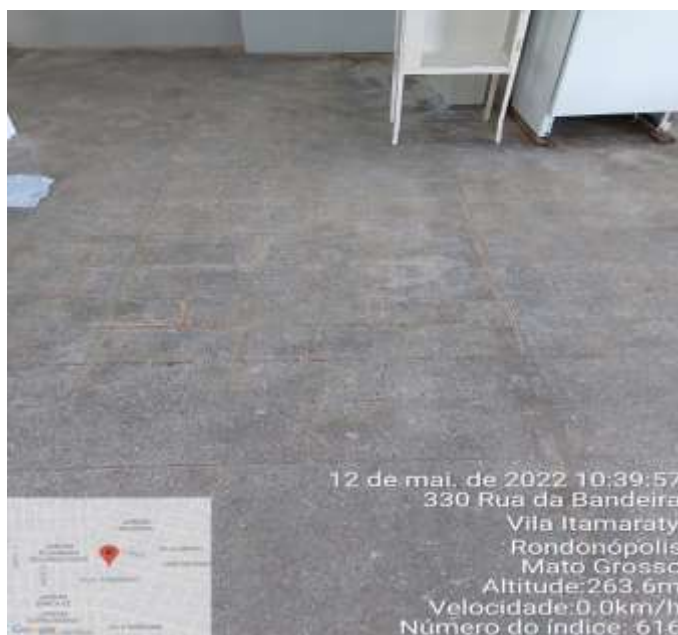
Foto 09 – Piso granilite manchado de ferrugem da malha de ferro Que deixaram na recepção, falta limpar e passar resina
