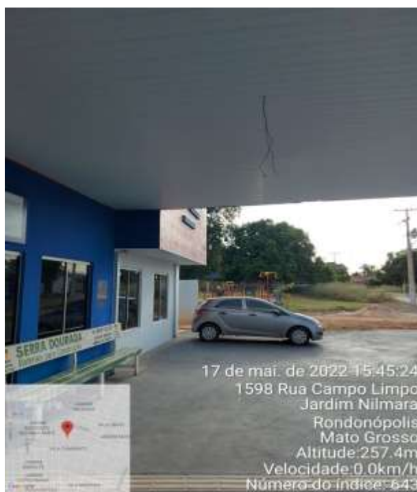
Foto 06 – faltam todas luminárias do lado externo.
