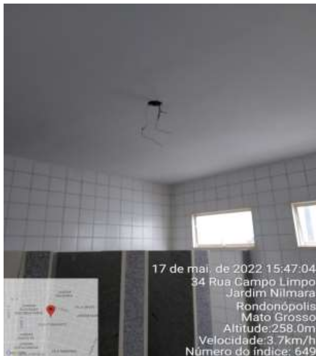
Foto 07 – falta colocar luminárias nos banheiros da recepção.
