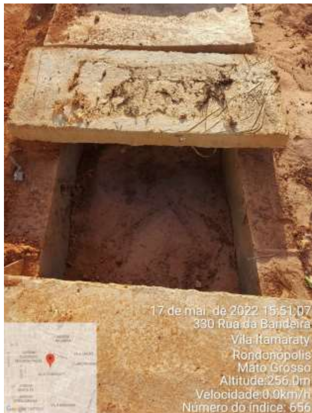
Foto 01 – Falta limpar a grelha e assentar as peças pré fabricadas.
