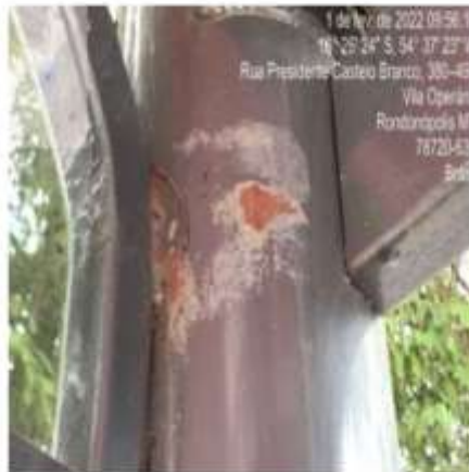
Foto 39: abrigo localizado próximo à loja Martinelo na Praça Bom Jesus está com falha na pintura e oxidação do tubo.
