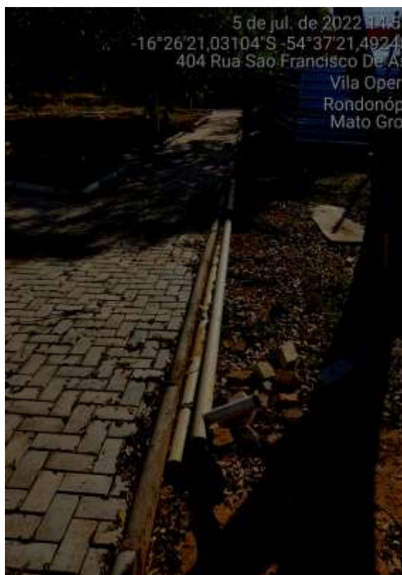
Postes removidos e armazenados de maneira negligente
