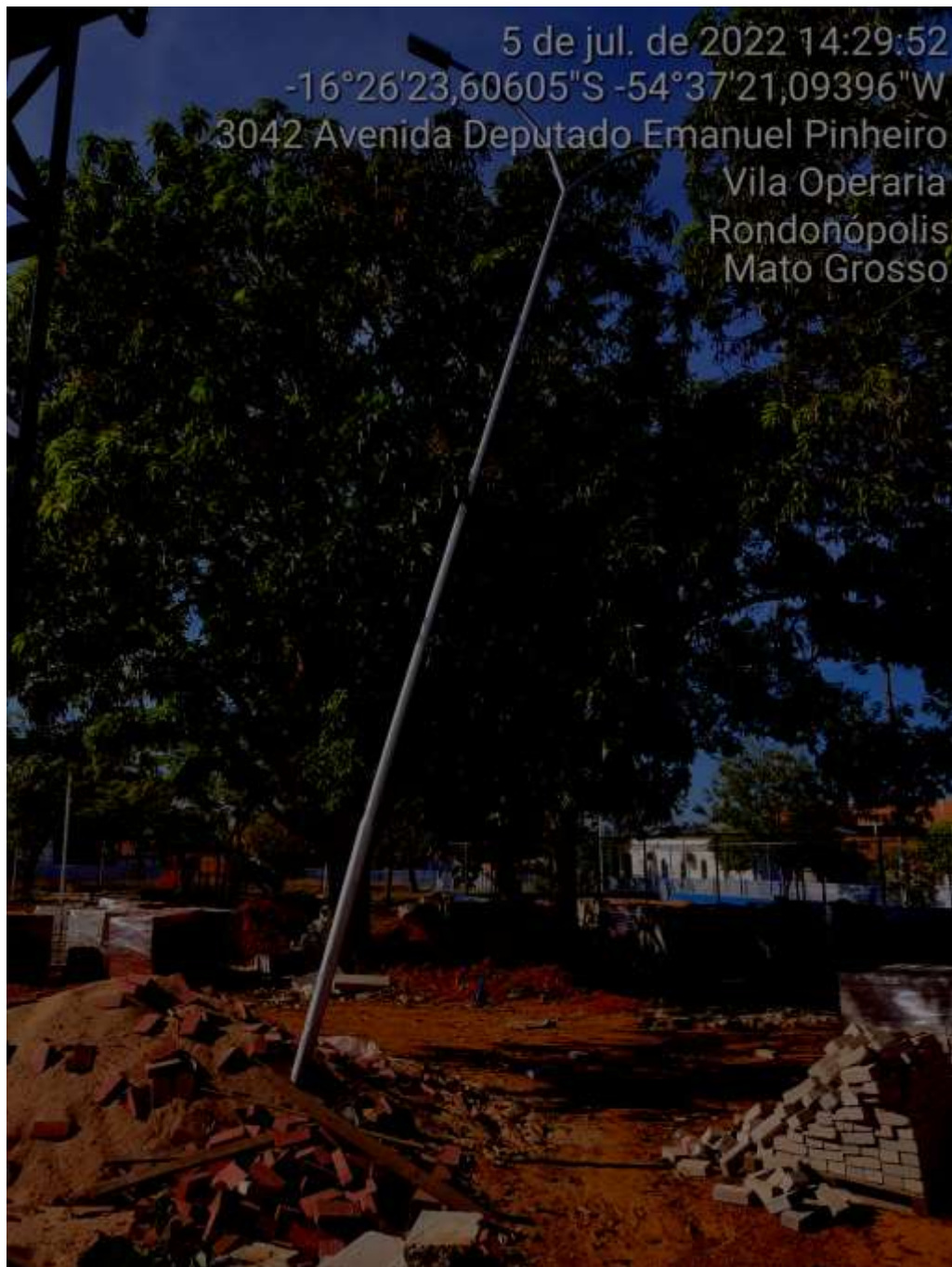
Poste amassado com pintura danificada.
