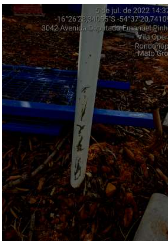
Poste inclinado com pintura danificada
