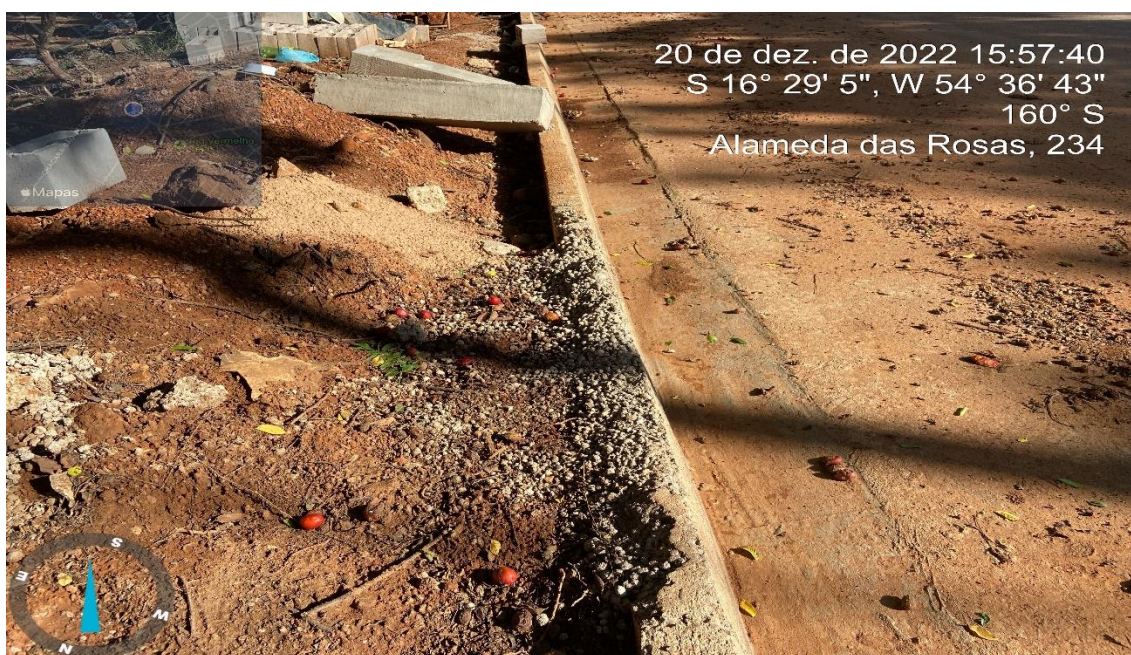
Foto 06 – Patologias na execução do meio-fio.
