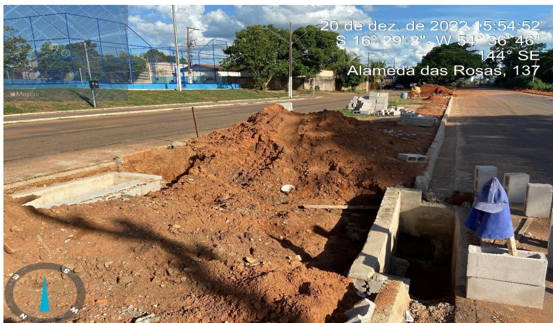
Foto 01 – Bocas de lobo sem conclusão.
