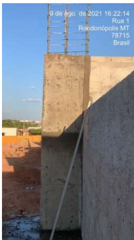
Foto 04 – Pilar fora do prumo
