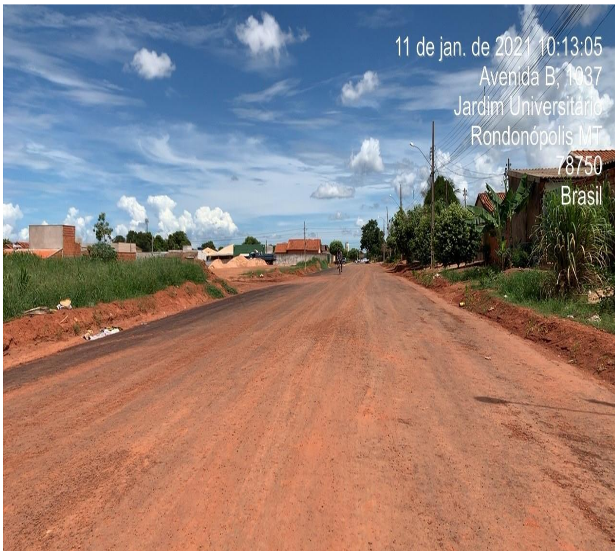
Foto 10 – Após imprimado e passado meses, não foi aplicado revestimento asfáltico.
