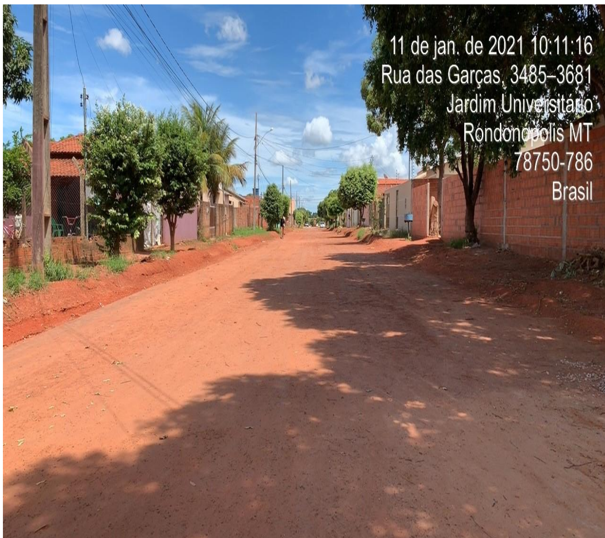
Foto 06 – Novamente observamos que após virar o ano e passado meses, a aplicação de revestimento não foi executada.
