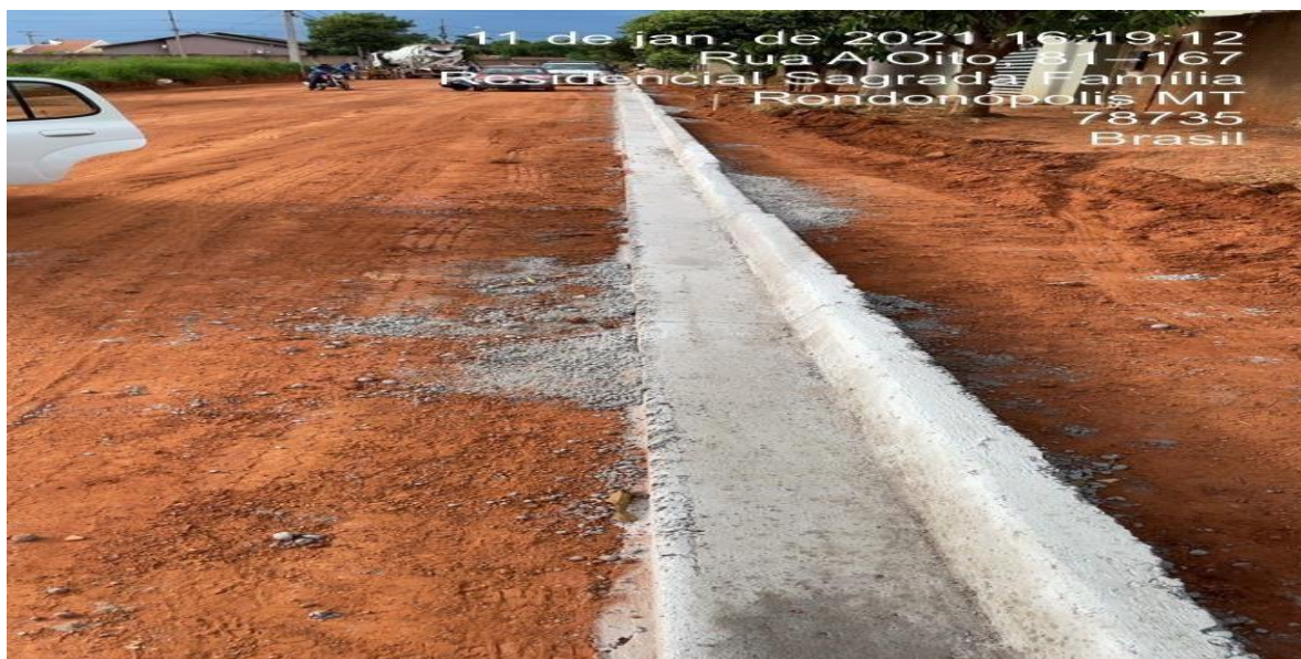
Foto 02 – Apresenta a coloração branca, sem junta de dilatação apropriada.
