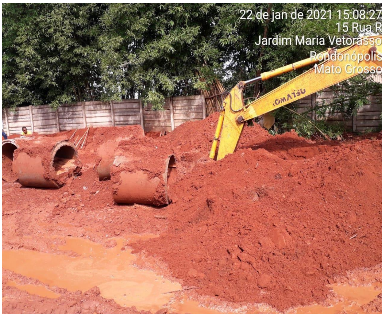
Foto 06 – Com o período chuvoso eminente, a foto acima ilustra o prejuízo causado as obras de drenagem.
