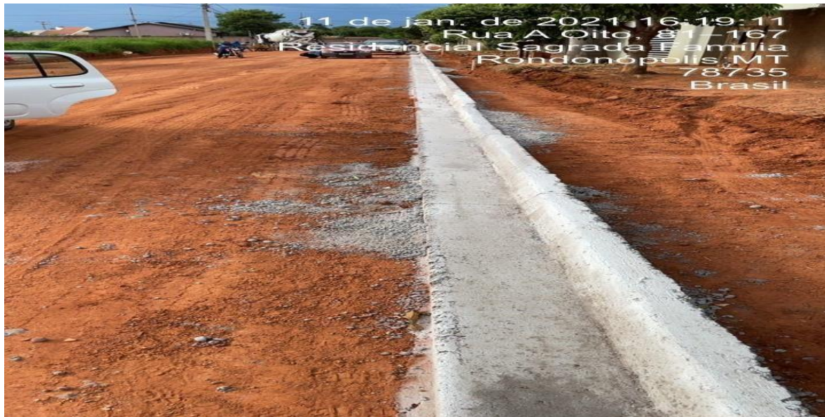
Foto 01 – Dia que foi moldado o meio fio (11/01/2021). Já apresentava a coloração branca, sem junta de dilatação apropriada.
