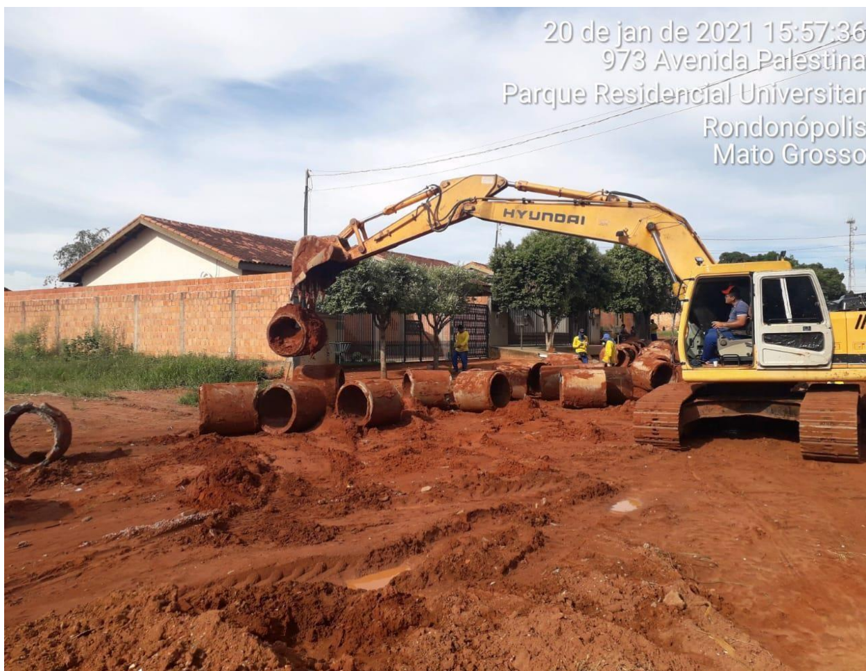
Foto 02 – A foto acima ilustra o prejuízo causado as obras de drenagem.
