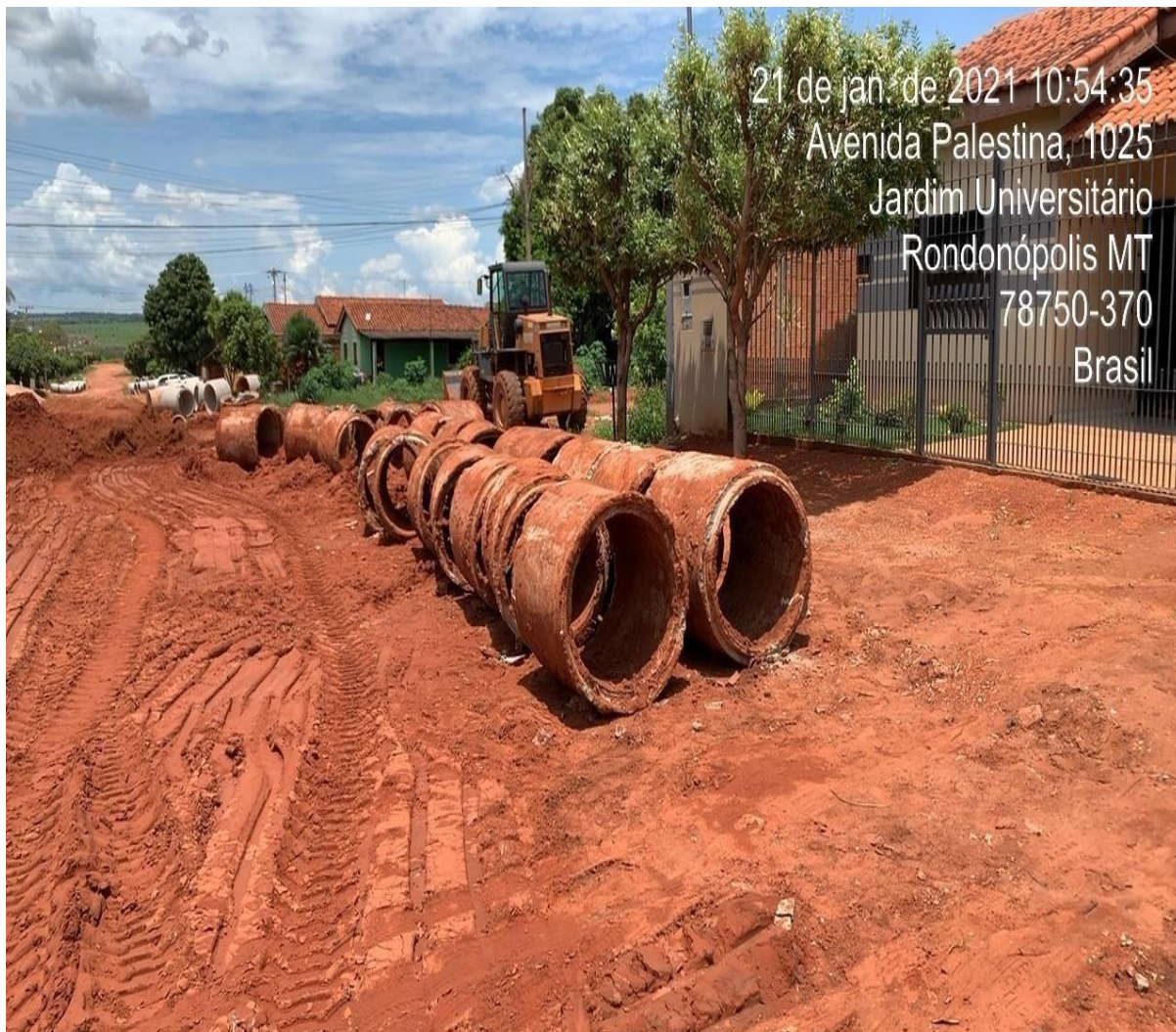
Foto 01 – Manilhas retiradas após patologias.
