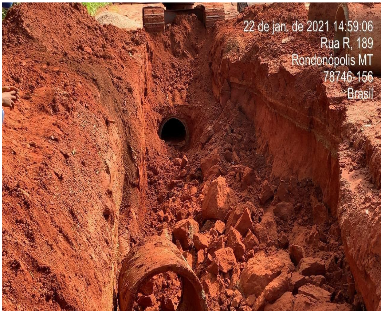
Foto 04 – Retirada de manilhas de concreto, serviço todo danificado.
