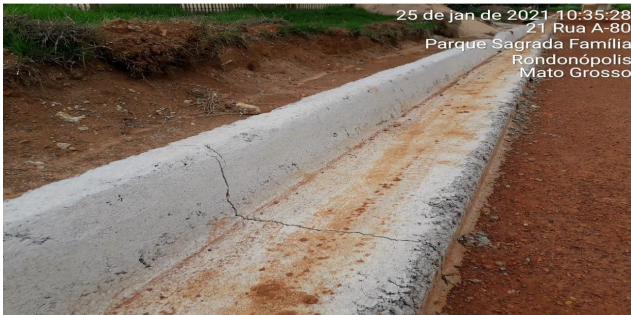
Foto 07 – Apresenta a coloração branca, sem junta de dilatação apropriada, 14 dias após a moldagem, o elemento apresenta esfarelamento, rachaduras por falha de junta de dilatação.
