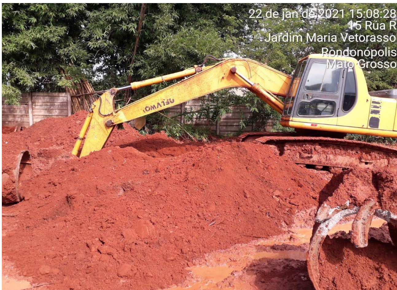
Foto 05 - Com o período chuvoso eminente, a foto acima ilustra o prejuízo causado as obras de drenagem.
