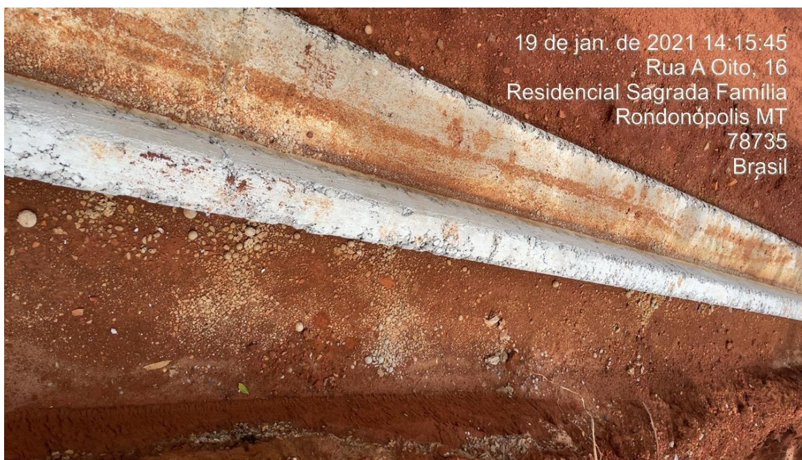
Foto 04 – Apresenta a coloração branca, sem junta de dilatação apropriada, oito dias após a moldagem, o elemento apresenta esfarelamento.
