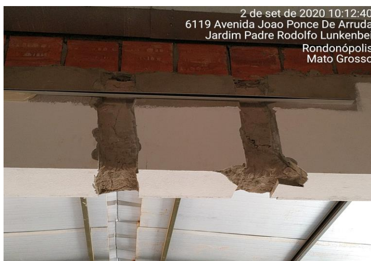
Foto 01 Vigas apresentando Trincas
