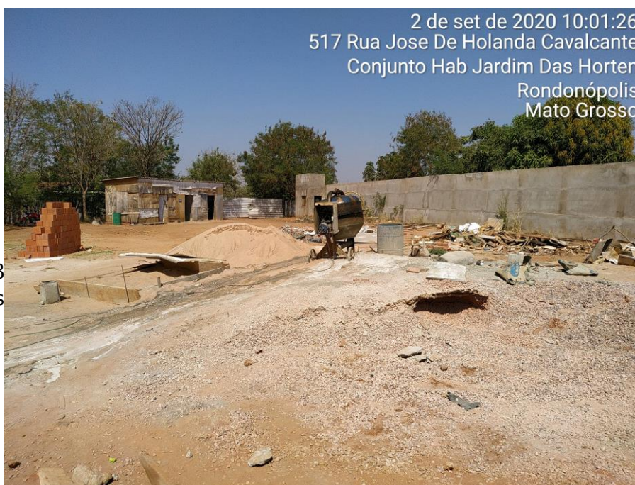
Foto 03 Canteiro de obras bagunçado
