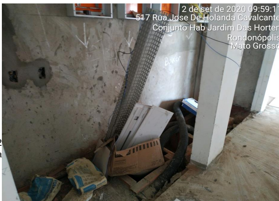
Foto 02 Materiais jogados em obra
