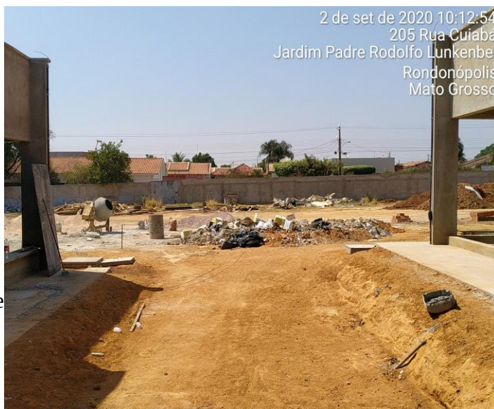
Foto 04 Canteiro de obra sujo e desorganizado
