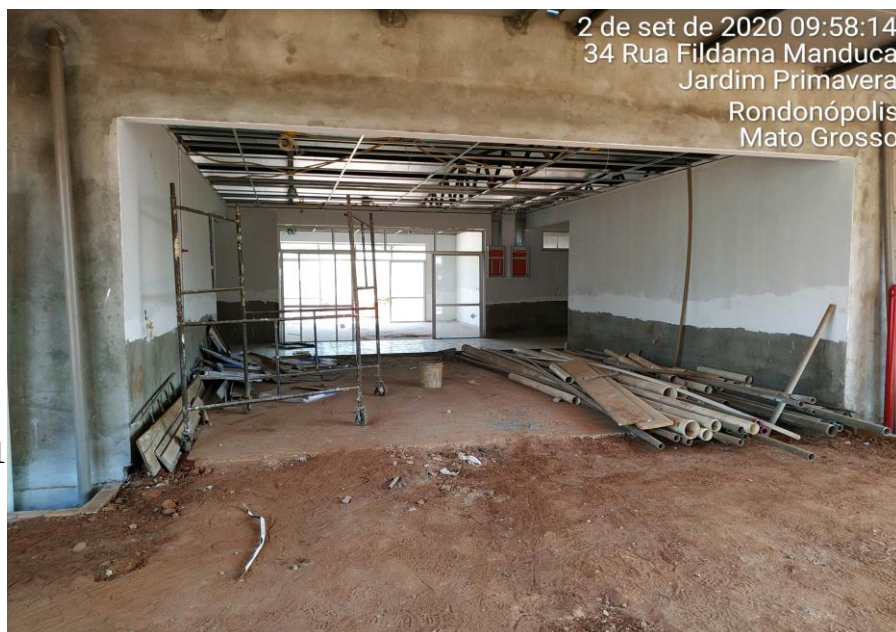
Foto 01 Desorganização em obra
