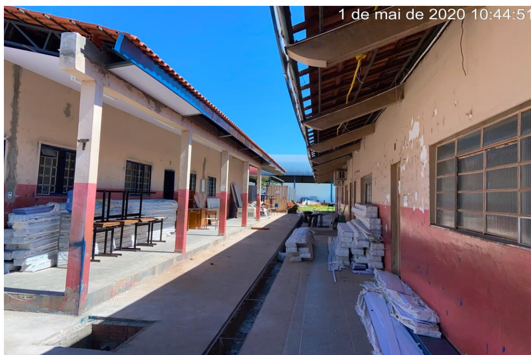
Imagem 02: Serviços começados e não concluídos (forro, tabeira e piso) no primeiro bloco desde o início da obra
