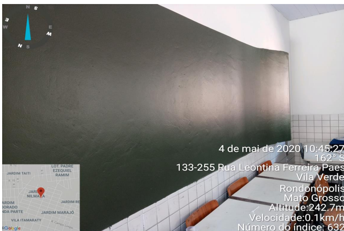
Imagem 01: Quadro escolar sem o acabamento adequado, com vários buracos e ondulações
