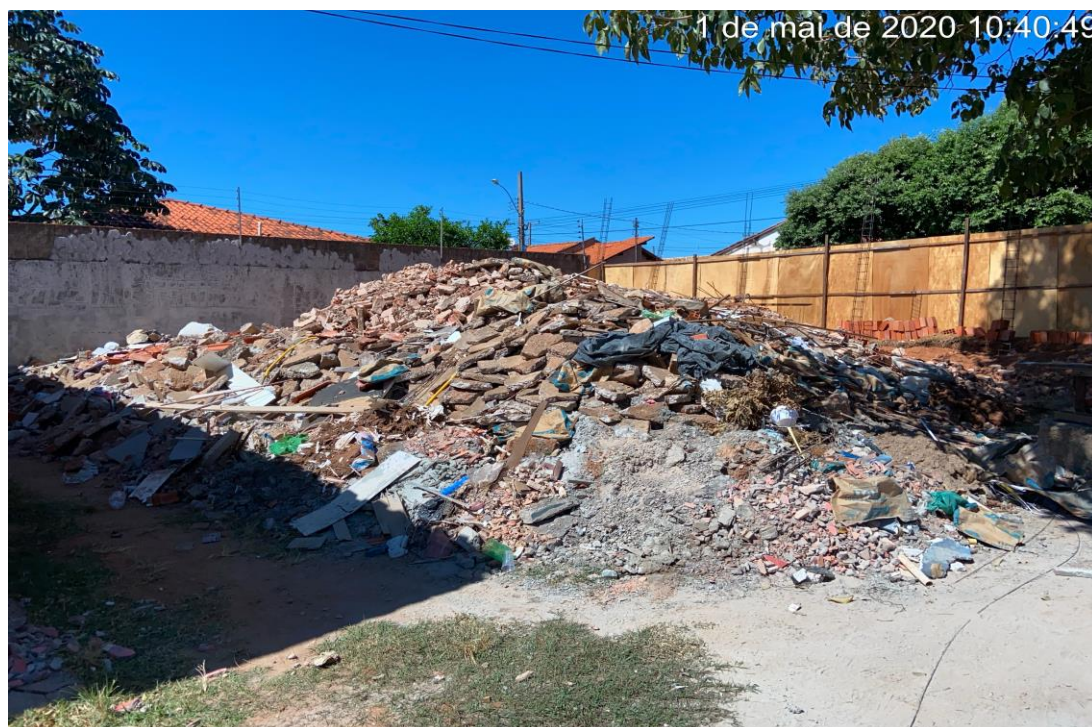
Imagem 04: Armazenamento de grande quantidade de entulho no canteiro de obra, causando transtorno e risco aos que ali trafegam.
