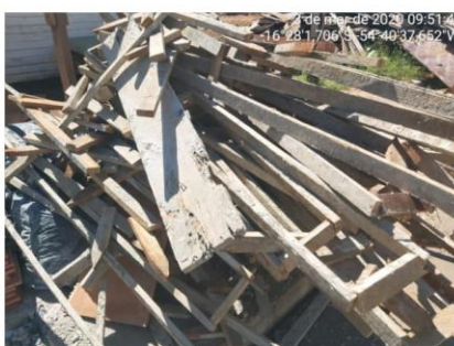
FOTO 02 - ENTULHOS NÃO FORAM RETIRADOS E ESTÃO JOGADOS NO TERRENO AO LADO.
