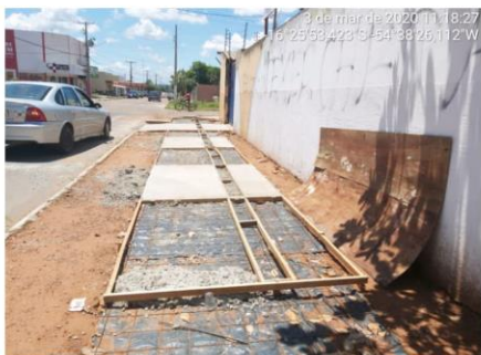
FOTO 03- CALÇADA INACABADA E SEM FUNCIONÁRIOS NO LOCAL.
