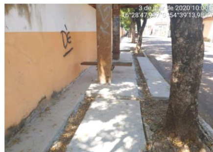
FOTO 04– CALÇADA LATERAL APENAS CONCRETADA , SEM PISOS TÁTEIS, E SEM O PLANTIO DE GRAMA.
