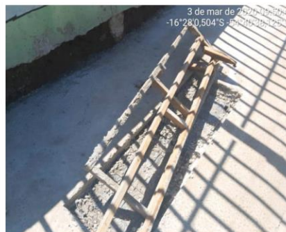
FOTO 04- NÃO FORAM COLOCADOS OS PISOS TÁ-TEIS, E AS FORMAS ESTÃO EXPOSTAS E JOGADAS TRAZENDO RISCOS AS CRIANÇAS.
