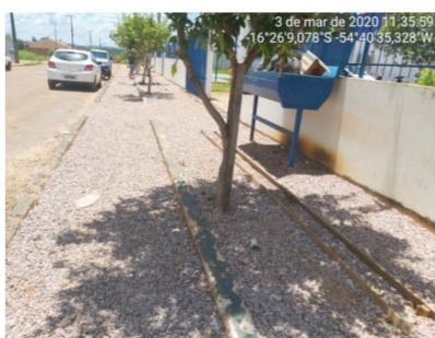
FOTO 03– CALÇADA APENAS COM LASTRO DE BRITA .
