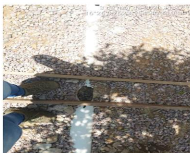
FOTO 04– NA DEMOLIÇÃO DA CALÇADA HOUVE A QUEBRA DE UM TUBO PARA PASSAGEM DE ÁGUA PLUVIAL, QUE NÃO FOI SUBSTITUÍDO.
