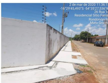
FOTO 02– CALÇADA INACABADA E SEM OS PISOS TÁTEIS.
