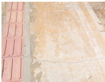
FOTO 03– CALÇADA JÁ SOLICITADA PARA SER REFEITA JÁ HAVENDO RACHADURAS.
