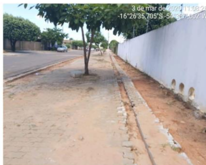
FOTO 03- CALÇADA DEMOLIDA E SEM OS PISOS TÁTEIS.
