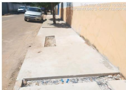
FOTO 03– CALÇADA APENAS CONCRETADA , SEM PI- SOS TÁTEIS.
