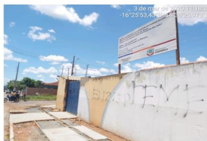
FOTO 02- CALÇADA NÃO FOI TOTALMENTE EXECUTADA.
