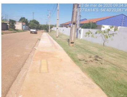
FOTO 02– CALÇADA QUE DEVERÁ SER REFEITA.
