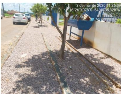
FOTO 03– CALÇADA APENAS COM LASTRO DE BRITA .
