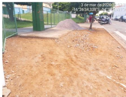
FOTO 04- CALÇADA DE ACESSO A UNIDADE SEM A CONCRETAGEM.
