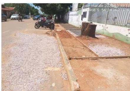
FOTO 01– U.M.E.I JESSICA ADRIANA FERREIRA LIMA, CALÇADA INACABADA E SEM FUNCIONÁRIOS NO LOCAL.
