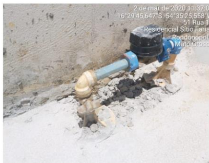
FOTO 03– CALÇADA SEM OS DEVIDOS ACABAMENTOS FINAIS.
