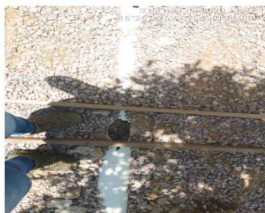
FOTO 04– NA DEMOLIÇÃO DA CALÇADA HOUE A QUEBRA DE UM TUBO PARA PASSAGEM DE ÁGUA PLUVIAL, QUE NÃO FOI SUBSTITUIDO.
