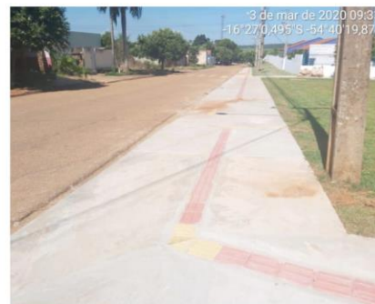
FOTO 04– PISO ALERTA COLOCADO INDEVIDAMENTE.
