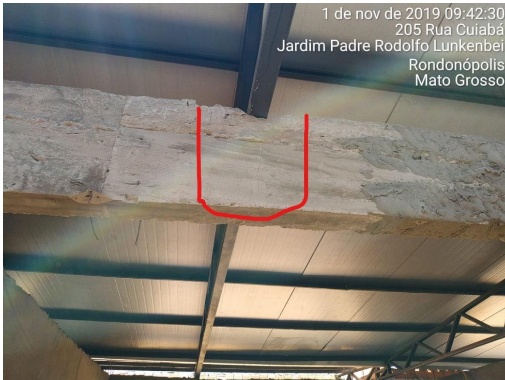
Foto 02 – Vigas com patologias apresentadas.
