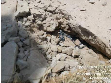
Foto 01 – Calçada sendo executada sem a malha de ferro.
