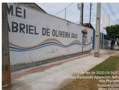
Foto 01- Calçada da Unidade Gabriel de Oliveira Aparentemente com o traço inferior da planilha lícitada onde o concreto encontra-se com o aspecto claro, aparentando ter sido usado mais areia do que cimento, assim causando má qualidade do concreto. E sendo executada sem a malha de ferro.
