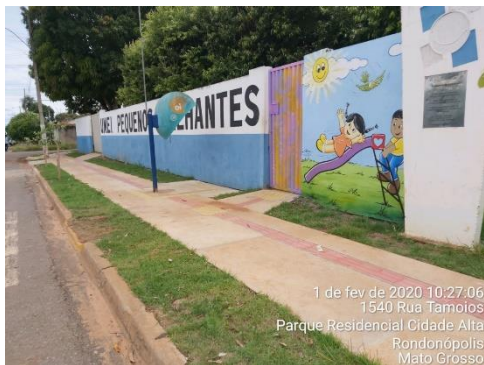
Foto 02- Calçada sendo executada sem malha de ferro apresentando fissuras, e sem acessibilidade para a calçada ao lado.
