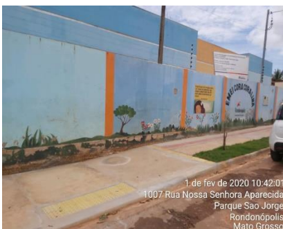
Foto 01- Calçada da Emef Cora Coralina, contendo varias fissuras, executada sem malha de ferro, e aparentemente com traço inferior a planilha licitada.
