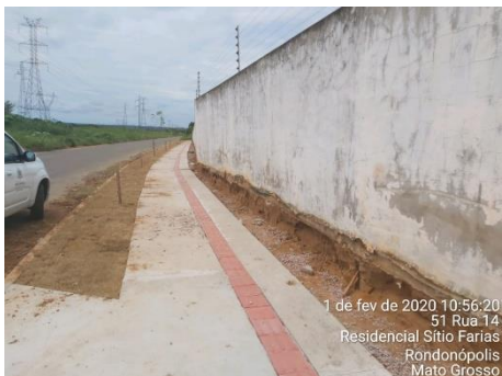
Foto 03- Calçada executadas sem a malha de ferro, Apresentando fissuras.
