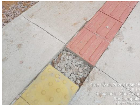
Foto 02- Calçada da Unidade Maria Severina aparentemente com o traço inferior da planilha licitada, onde o concreto encontra-se com o aspecto claro, aparentando ter sido usado mais areia do que cimento, assim causando má qualidade do concreto.
