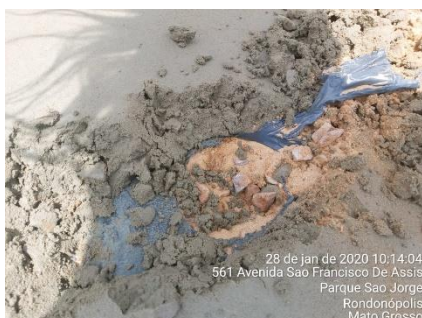
Foto 01- Calçada da Unidade José dos Reis Sales sendo executada sem malha de ferro, conforme vistoriado in loco pela fiscal de obras, no momento execução de concretagem da mesma.
