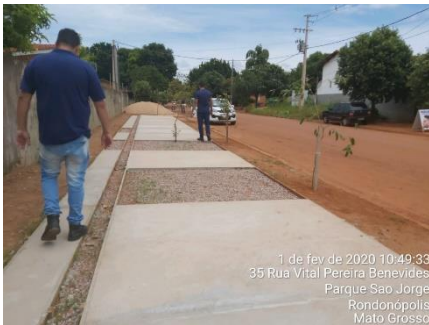
Foto 02- Calçada da Unidade José dos Reis Sales sendo executada sem malha de ferro, conforme vistoriado in loco pela fiscal de obras.
