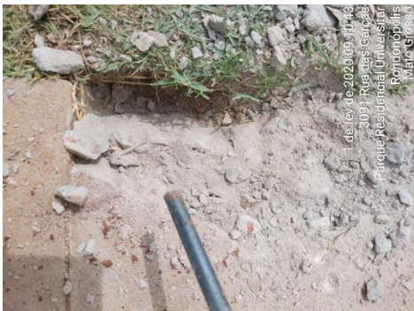
Foto 02- Calçada da Unidade Profº Ivan Santos Arruda sendo executada sem malha de ferro, conforme vistoriado in loco pela fiscal de obras.
