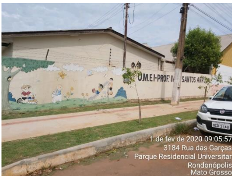
Foto 01- Calçada da Unidade Profº Ivan Santos Arruda aparentemente com o traço inferior da planilha licitada onde o concreto encontra-se com o aspecto claro, aparentando ter sido usado mais areia do que cimento, assim causando má qualidade do concreto, não sendo executado da maneira correta.
