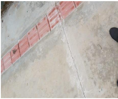
Foto 02- Calçada sendo executada sem malha de ferro apresentando fissuras.
