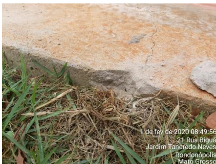
Foto 03- Calçada da Unidade Joana Maria aparentemente com o traço inferior da planilha licitada onde o concreto encontra-se com o aspecto claro, aparentando ter sido usado mais areia do que cimento, assim causando má qualidade do concreto.
