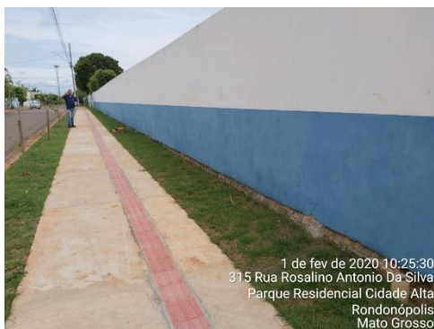
Foto 01- Calçada da Unidade Pequenos Brilhantes Aparentemente com o traço inferior da planilha licitada onde o concreto encontra-se com o aspecto claro, aparentando ter sido usado mais areia do que cimento, assim causando má qualidade do concreto. E sendo executada sem a malha de ferro.
