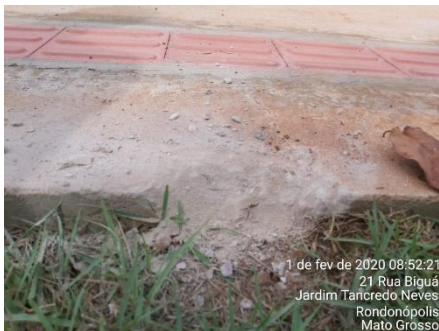
Foto 02- Calçada da Unidade Joana Maria aparentemente com o traço inferior da planilha licitada, onde o concreto encontra-se com o aspecto claro, aparentando ter sido usado mais areia do que cimento, assim causando má qualidade do concreto. Sendo, ainda, executada sem a malha de ferro.
