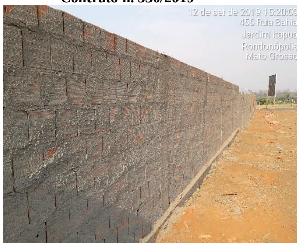
Foto 01 – Pilar executado com seção menor do que especificado em planilha licitada.
