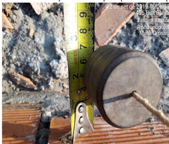
Foto 02 – Conferência de prumo, parede esta 04 cm fora de eixo na vertical.
