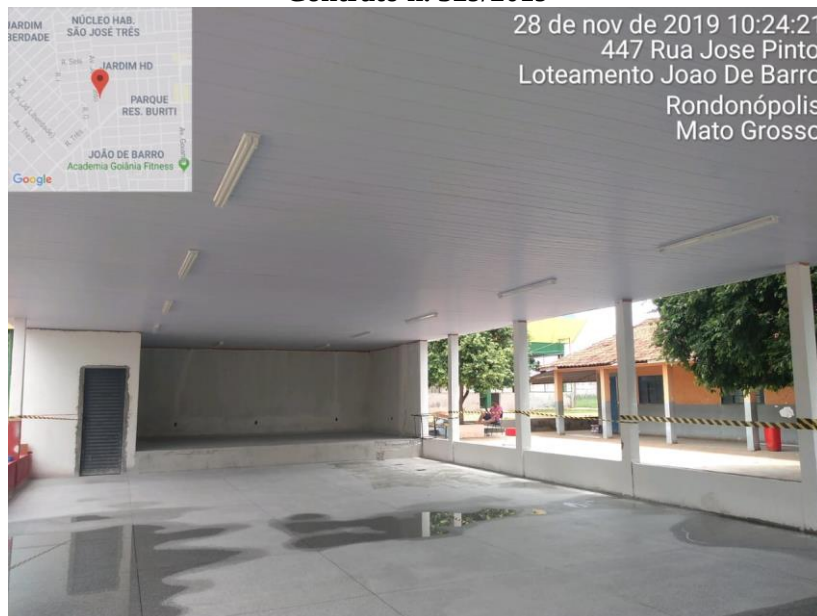
Foto 01 – Serviços inacabados e atrasados.
