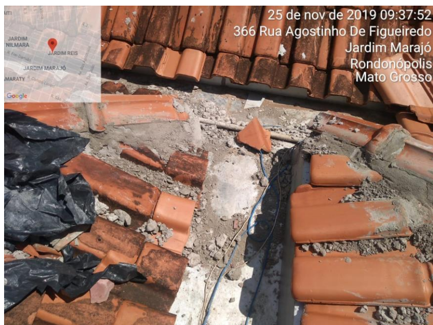
FOTO 02- SERVIÇOS MAL EXECUTADOS E CUMEEIRA COLOCADA DE FORMA INCORRETA.
