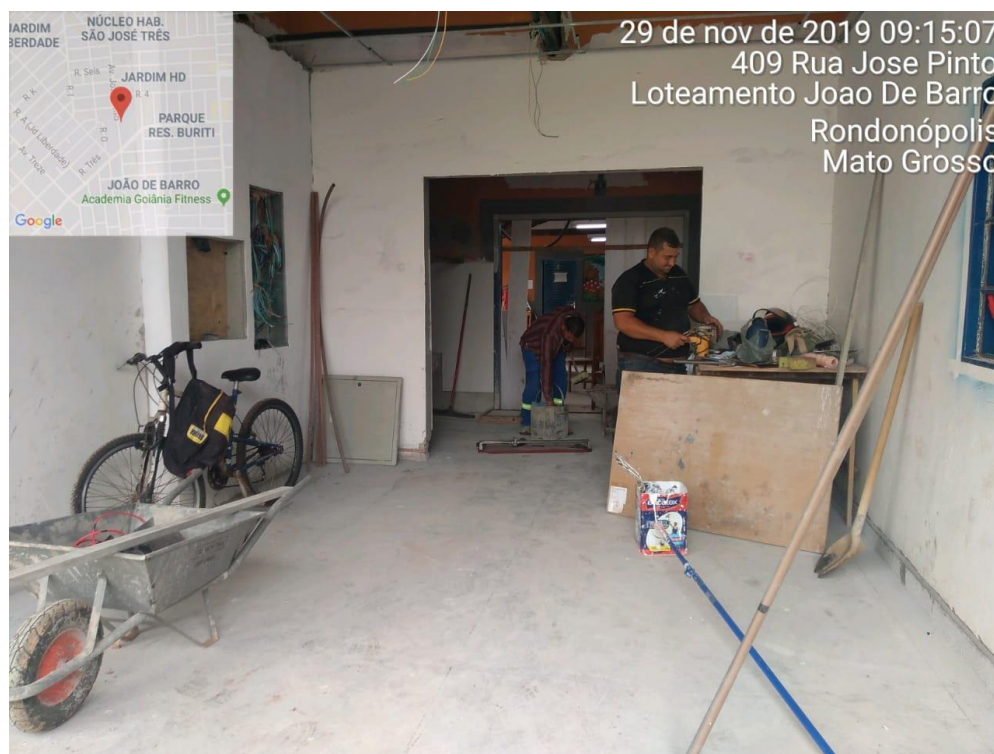
Foto 03 – Alvenaria e quadro de distribuição que deverão ser refeitos.
