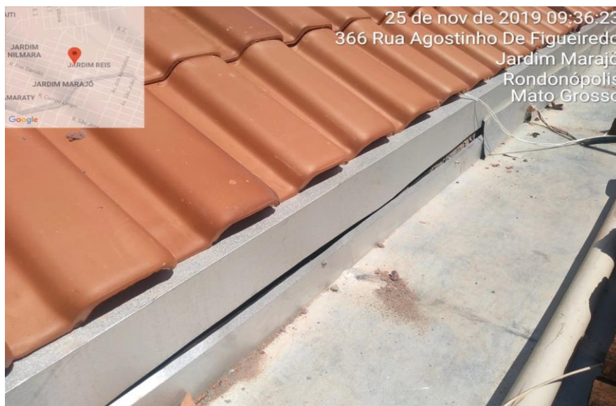
FOTO 04- CALHA NÃO VEDADA E MAL EXECUTADA
