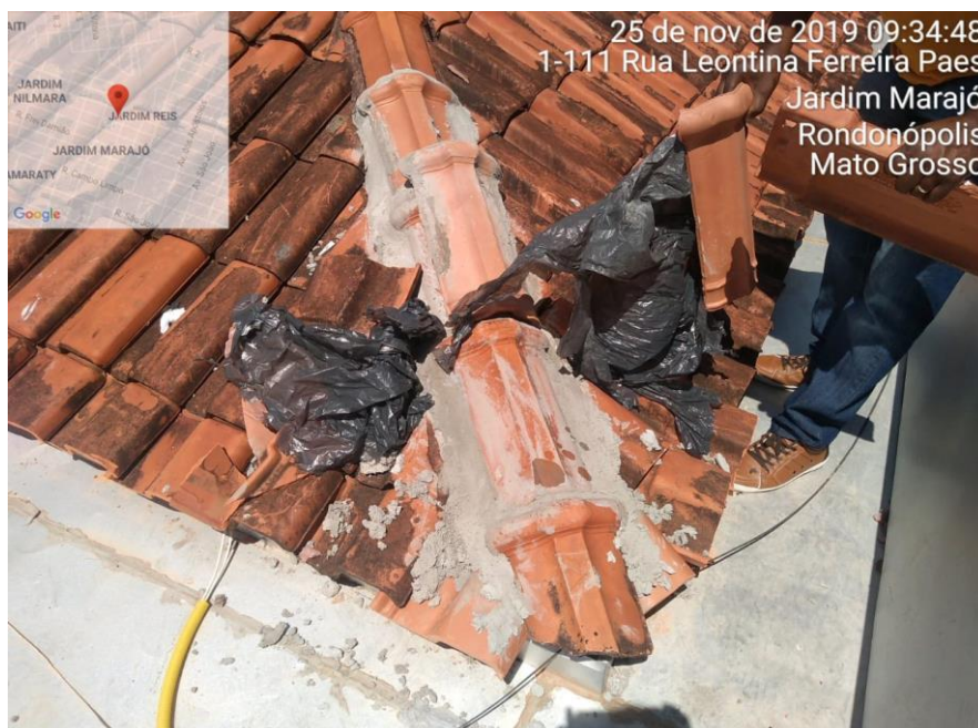
FOTO 03- SERVIÇO EXECUTADO SEM HAVER A LIMPEZA NO FINAL.
