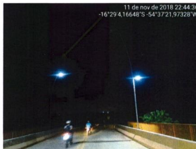
Foto 04 - LUMINÁRIAS APAGADAS NA PONTE DO PROLONGAMENTO DA AVENIDA LIONS
