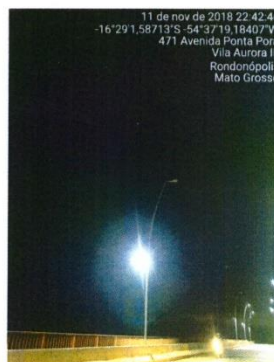
Foto 06 - LUMINÁRIAS APAGADAS NA PONTE DO PROLONGAMENTO DA AVENIDA LIONS
