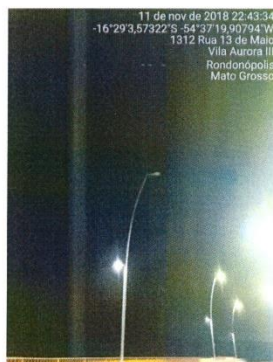
Foto 05 - LUMINÁRIAS APAGADAS NA PONTE DO PROLONGAMENTO DA AVENIDA LIONS
