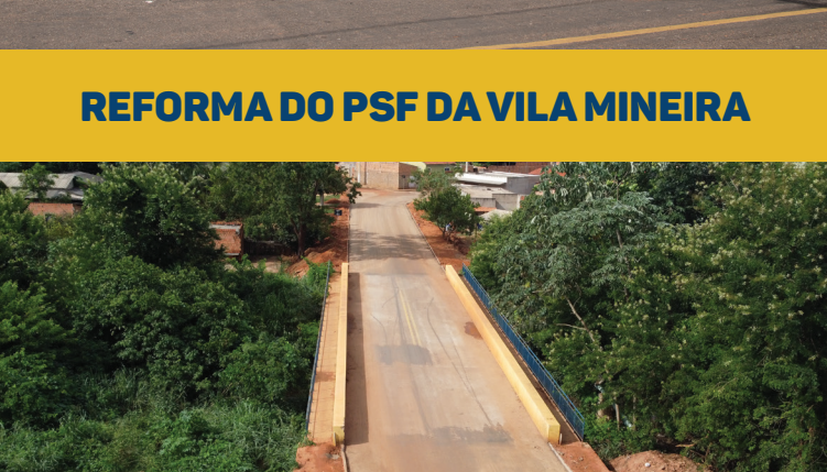
CONSTRUÇÃO DA PONTE DE ACESSO AO RESIDENCIAL TRÊS PODERES AO FINAL DA RUA JOSÉ BARRIGA
