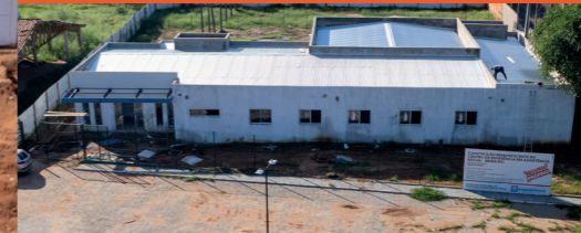
EM ANDAMENTO CONSTRUÇÃO DO CRAS BEIRA RIO CENTRO DE REFERÊNCIA E ASSISTÊNCIA SOCIAL
