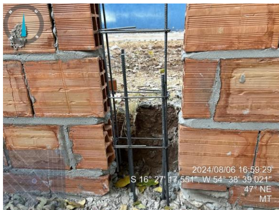
Figura 7 (Armadura do pilar com diâmetro menor do que a norma permite e divergente ao projeto e planilha licitada)
