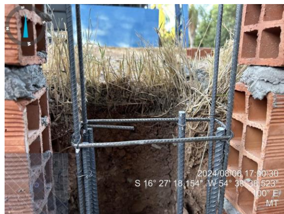
Figura 8 (Armadura do pilar com diâmetro menor do que a norma permite e divergente ao projeto e planilha licitada)
