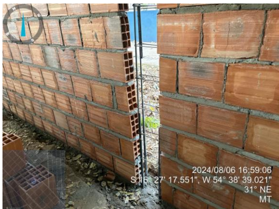
Figura 5 (Armadura do pilar com diâmetro menor do que a norma permite e divergente ao projeto e planilha licitada)
