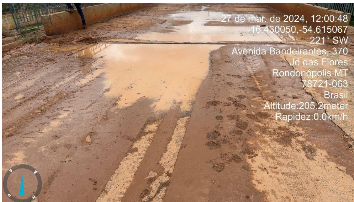
Foto 02 – Recalque na cabeceira da Ponte.
