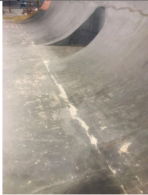
Imagem 02 – Trinca presente na junta da pista
