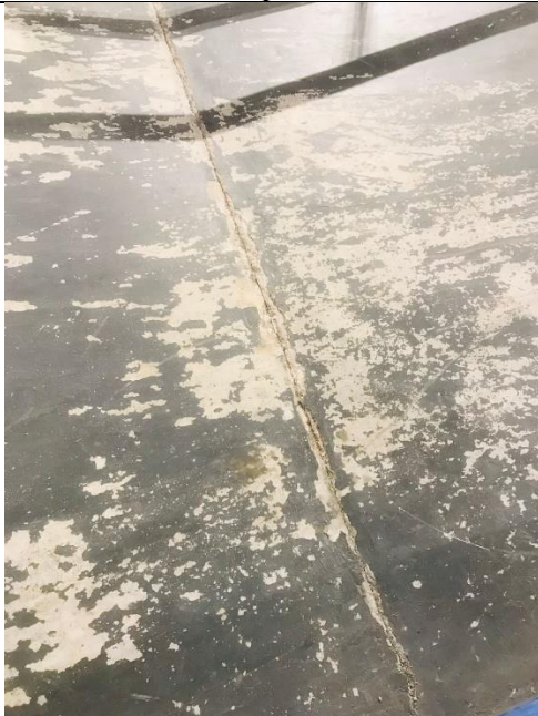
Imagem 03 – Trinca presente em junta da pista
