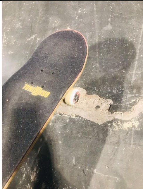
Imagem 04 – Esfarelamento do concreto na pista
