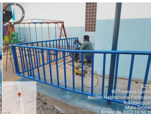
PINTURA EXECUTADA SEM A CONCLUSÃO TOTAL DA FABRICAÇÃO
