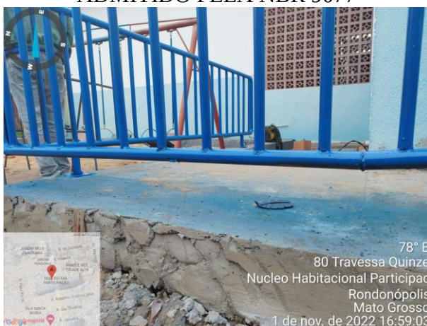
SOLDAS INCOMPLETAS E SEM ACABAMENTO
