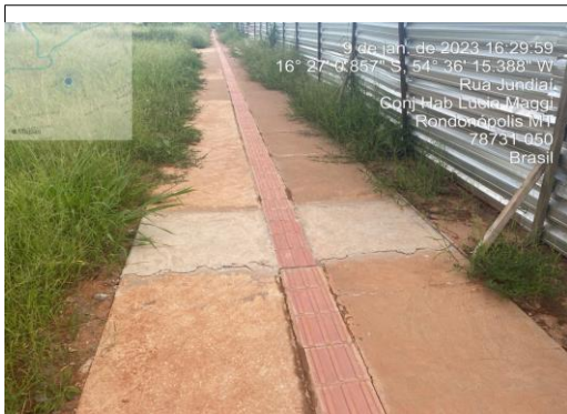
Figura 5: Passeio com rachadura.
