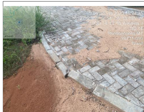
Figura 6: Meio-fio quebrados e sujeira nos passeios.
